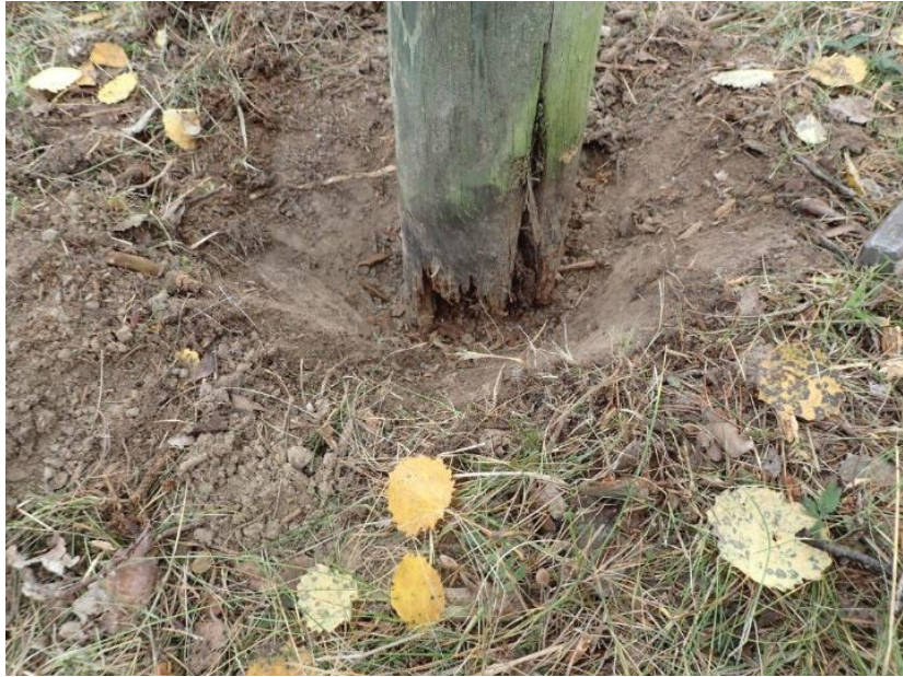
Trädstolpe med rötskador som behöver bytas till stål stolpe.
