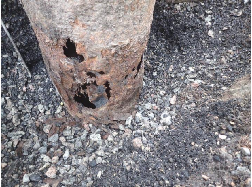
Gravt rostangripen stolpe som behöver bytas akut.
