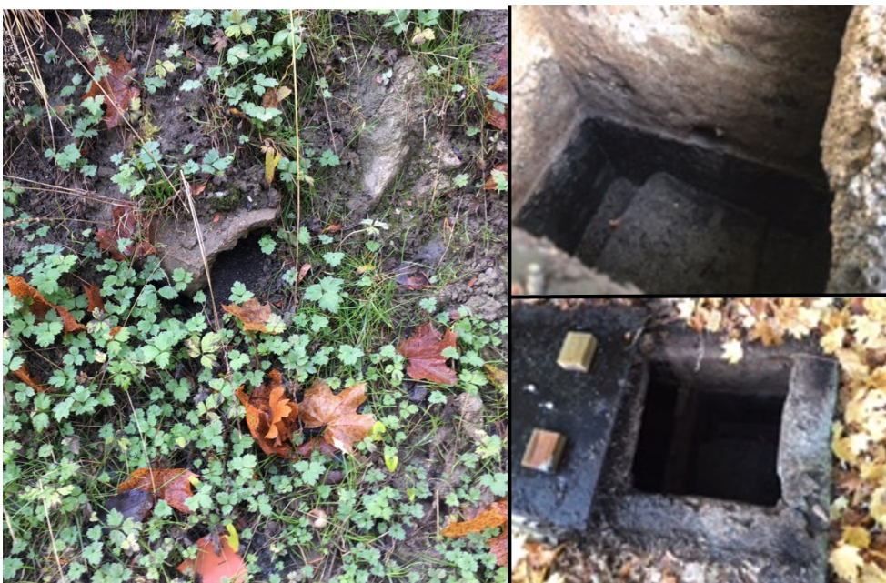
Figur 7. Bilden till vänster visar den trasiga betongledningen och bilden till höger visar avskiljaren. Foto: WRS 2020-10-13.
