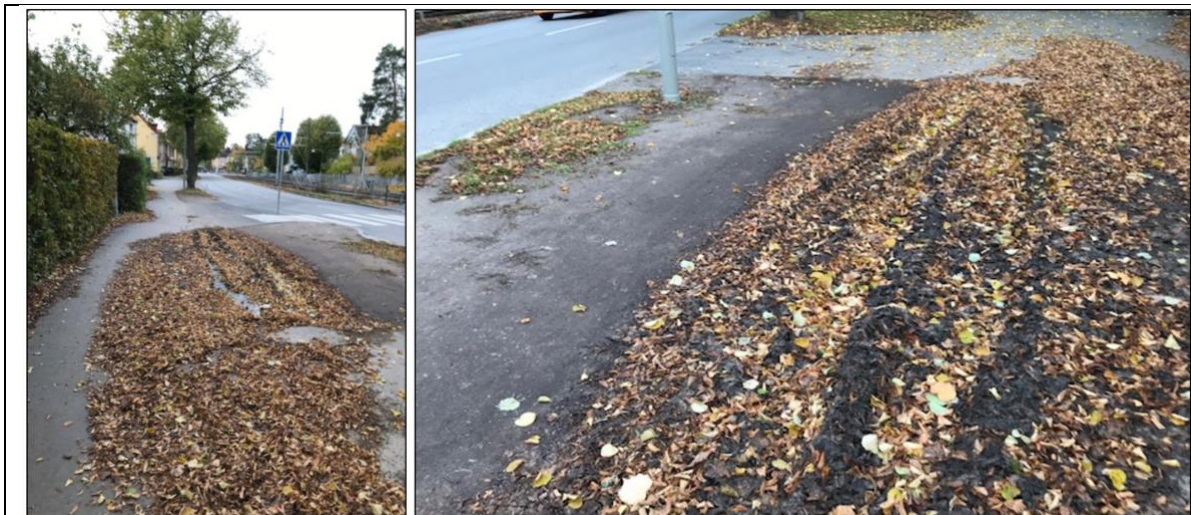
Figur 2. Stående vatten bildar en gyttjepöl som tar upp stora delar av gång- och cykelbanan.
