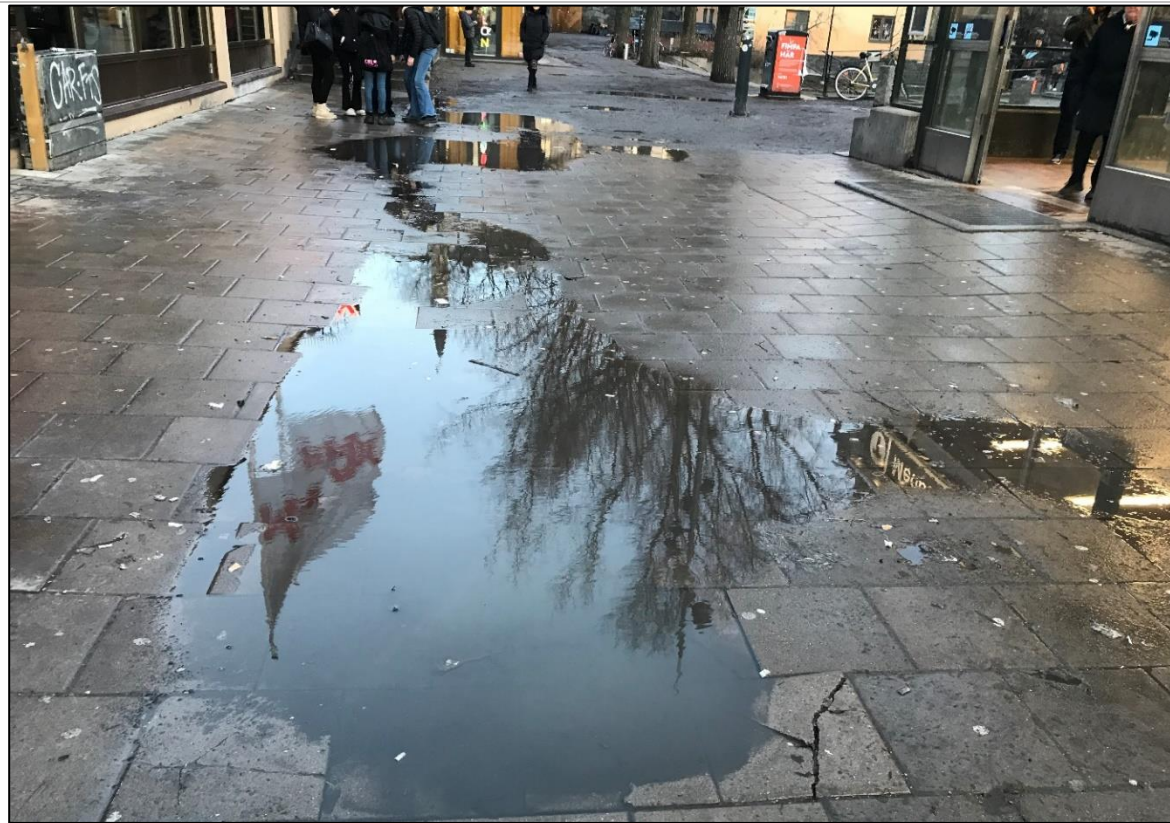
Figur 4. Plattyta vid T-baneentrén. Höjdsättnings- och avvattningsproblem.
