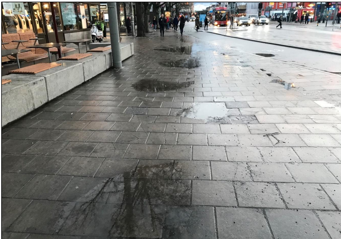
Figur 3. Plattyta mot Götgatan. Höjsättnings- och avvattningsproblem. Sättningar och sönderkörda plattor vid överfart för transportfordon.
