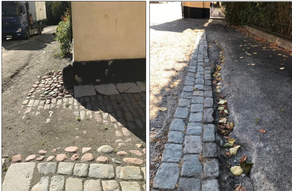
Figur 4. Erosionsskador syns på den privata fastigheten där vatten från gatan runnit in.
