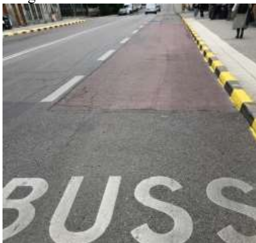
Bild 3. Exempel på hur en busshållplats med dagens konstruktion ser ut. Man kan tydligt se skarven mellan "vanlig" konstruerad väg och den rektangulära yta som gjutits i antingen betong eller cement.
