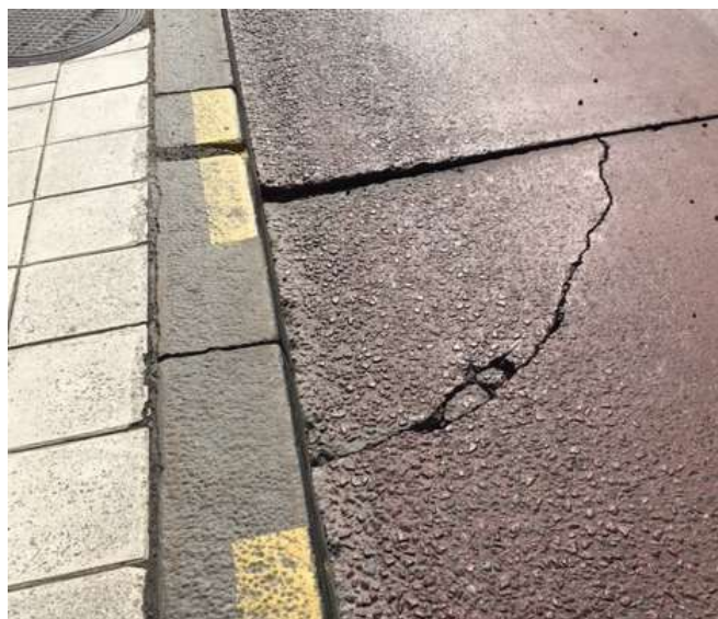
Bild 1. Skadad bussplatta vid Fleminggatan 26.
