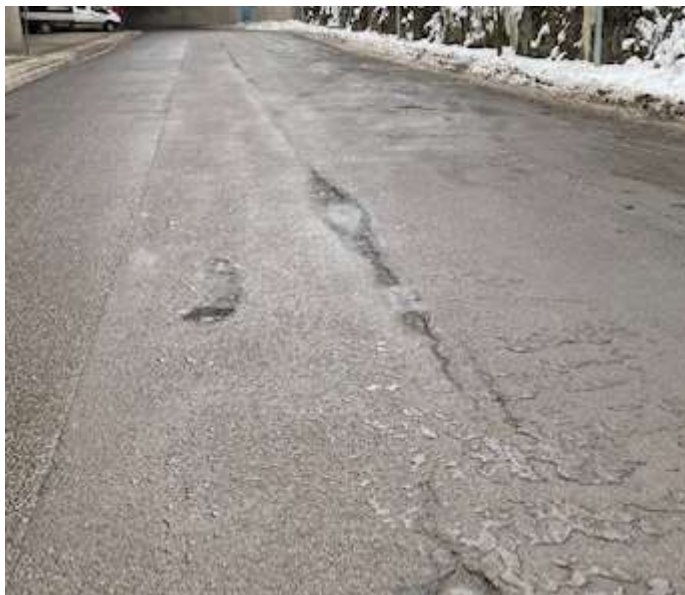
Bild 2. Skadad beläggning vid Kista Bussterminal.
