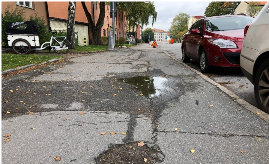
Bild 10. Underlaget på gångbanorna (här på Årstavägen) är bitvis ojämnt vilket påverkar vattenavrinningen.
