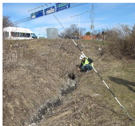
Bild 1. Utloppsledning som idag mynnar i en slänt vid Kvarnbacksvägen
