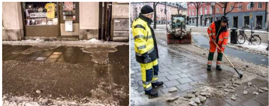
Isbildning vid stuprör kräver ofta manuellt arbete.
