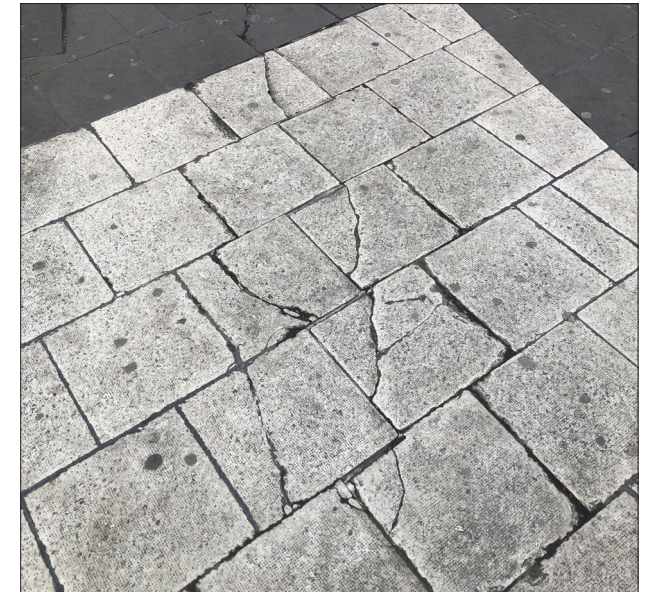
Figur 7. Spruckna och slitna plattor i betong.
