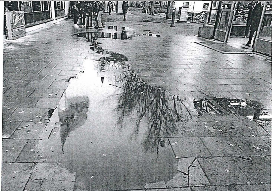
Plattyta vid T-baneentrén. Höjdsättnings- och avvattningsproblem.
