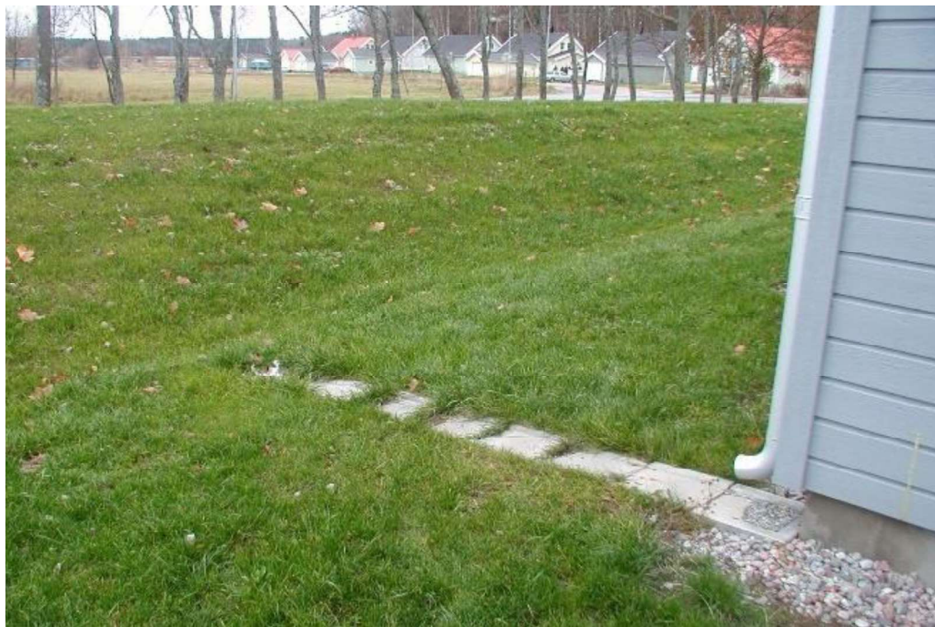
Figur 8. Exempel på takvatten som avleds via utkastare och rännal till mindre gräsmatta vidare mot lågområde/svackdike. Notera att marken sluttar bort från husen. Foto: WRS
