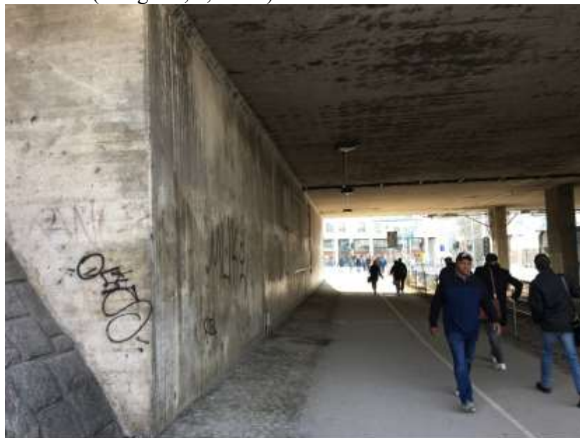
Figur 2. Bild före åtgärder, gångtunnel mellan Marievik och Liljeholmen.
