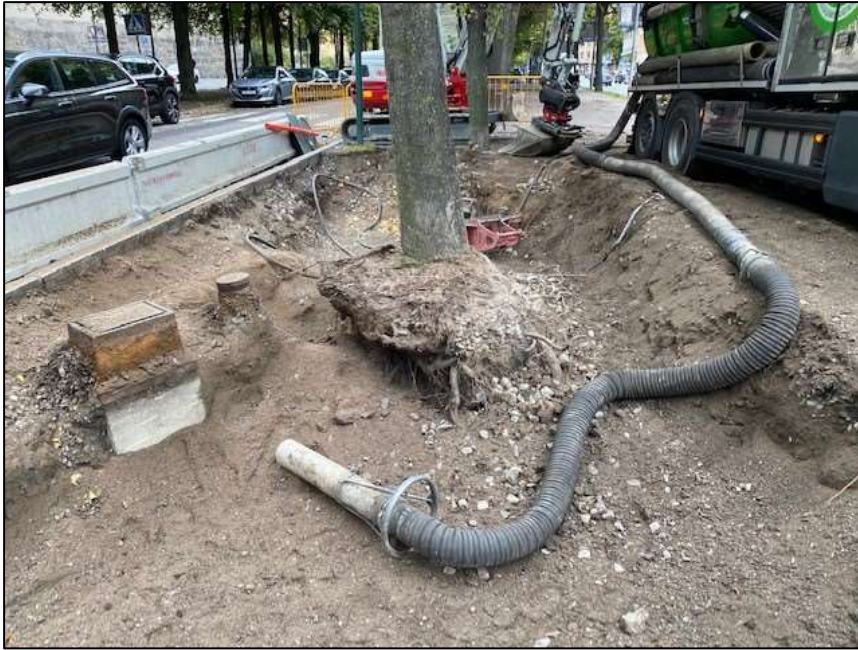
Figur 35. Vakuumschakt vid trädens rötter, östra sidan Narvavägen. Troligtvis är det tidigare ledningsschakt för brunnarna till vänster i bilden som har orsakat skadorna till rotsystemet som syns i bilden. Detta träd kommer ersättas.
