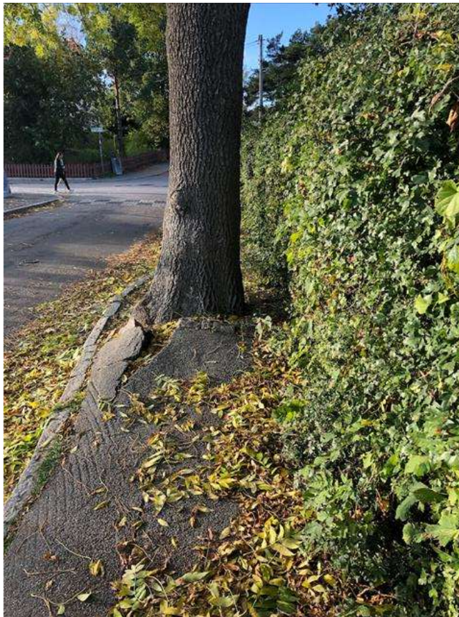
Figur 3: Träden på Pukslagargatan blockerar befintlig gångbana och skadar beläggningen.
