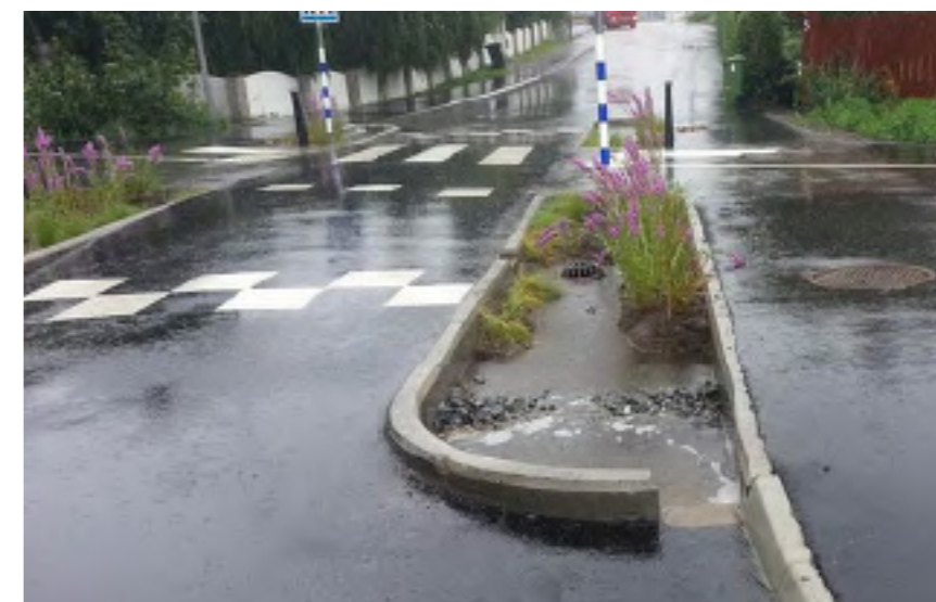
Exempel på välfungerade raingarden för lokalt ombändertagande av dagvatten i vägmiljö, Öringevägen i Tyresö.
