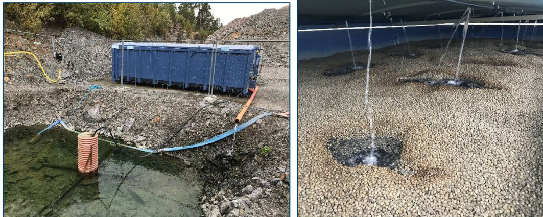
Figur 8. Fotografier över den biokolsbaserade reningsanläggningen. Det vänstra fotografiet visar reningsanläggningens utsida inklusive pump och rörledningen som matar anläggningen med vatten. Det högra fotografiet visar anläggningens insida samt fördelningssystemet i dess övre del.
