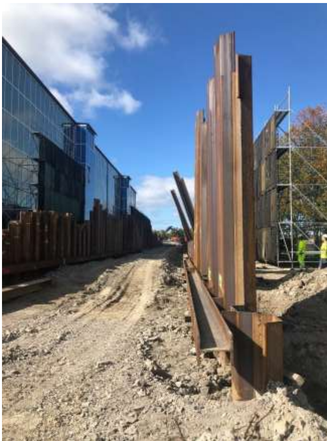
Figur 12. Spontningsarbeten i höjd med kvarteret Ferdinand. Till vänster ses nyuppförda studentbostäder. Längst till höger syns bullerplank som skydd för bostäder på andra sidan spåret. foto Miljöförvaltningen, Stefan Troëng
