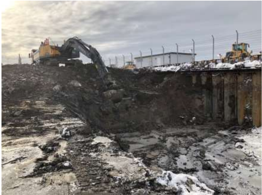
Figur 14. Schaktning för tvärbanan i höjd med Bromma flygplats. Foto: miljöförvaltningen, Stefan Troäng
