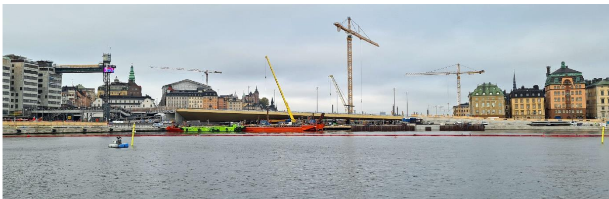
Slussens nya huvudbro "Guldbron" ligger sedan mars 2020 fast på sina stöd. Foto: Joakim Lücke.
