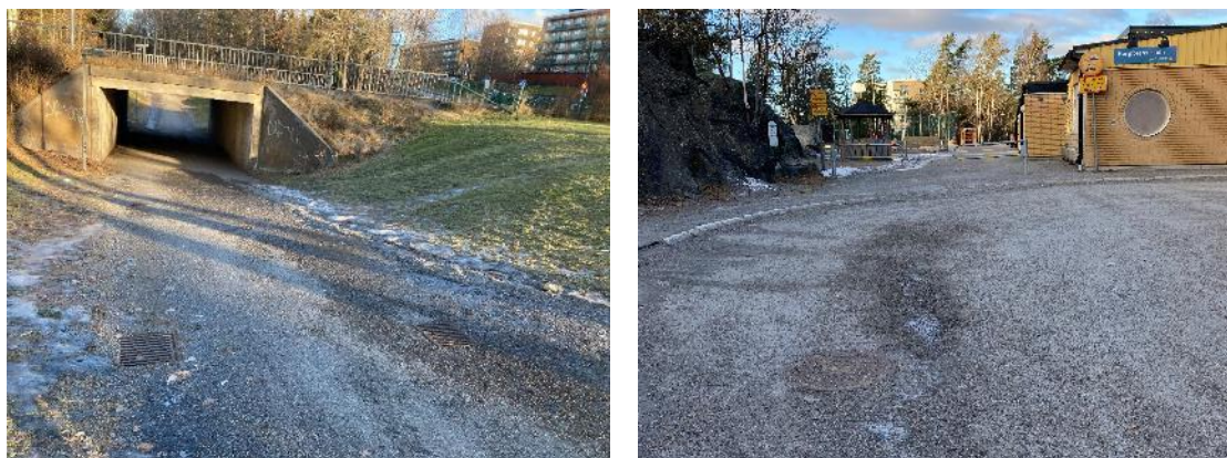
Figur 9. Gångtunneln under Njukärsvägen är en lågpunkt t.v. Hit rinner dagvatten från området vid ytavrinning. Vändplanen vid skolan är också en lågpunkt, t.h.
