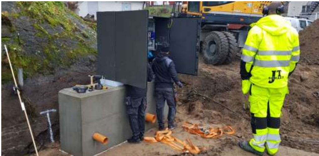
Installation av nytt el- och styrskåp utomhus med tillhörande betongfundament i PLC-projektet etapp 1
