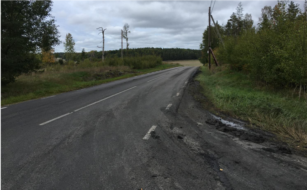
Figur 4 Slampspill på vägen den 22 september 2021, efter inledande sanering. Foto: Anna Herrgård 2021-09-22.
