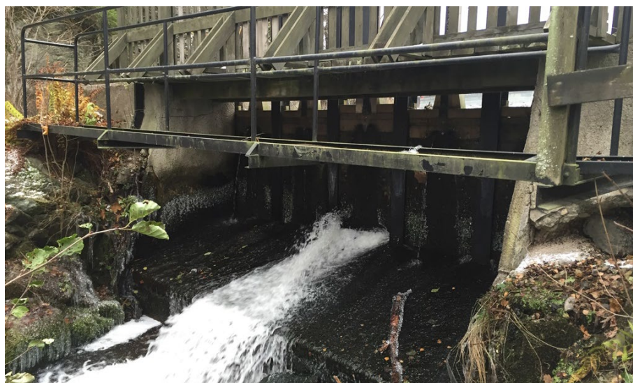
Fatbursdammen, ett av flera vandringshinder mellan Flatens och Tyresåns utlopp i Kalvfjärden. Foto: Michael Wzdulski
