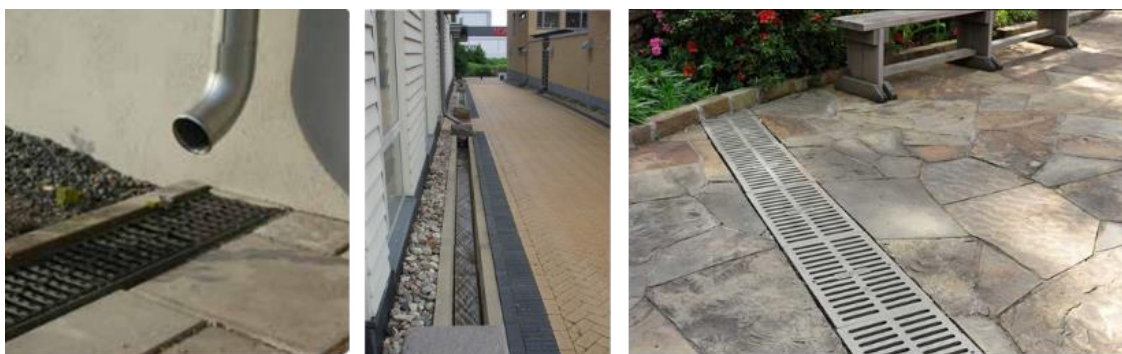
Figur 16. Exempel på takvattenavledning via rännor, bilden till vänster visar rännor med galler och bilden i mitten visar exempel på avledning i öppna rännor och bilden till höger visar en dagvattenränna som leder in dagvatten i en växtbädd. Foto till vänster: Uppsala Vatten, Foto i mitten: WRS, Foto till höger: (A1 Guaranteed, 2012).
