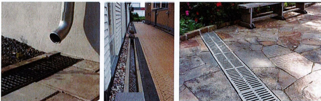
Figur 16. Exempel på takvattenavledning via rännor, bilden till vänster visar rännor med galler och bilden i mitten visar exempel på avledning i öppna rännor och bilden till höger visar en dagvattenränna som leder in dagvatten i en växtbädd. Foto till vänster: Uppsala Vatten, Foto i mitten: WRS, Foto till höger: (A1 Guaranteed, 2012).
