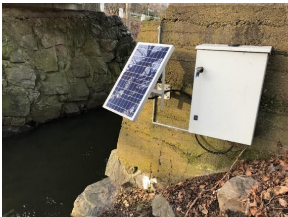
Skåp och solcell vid Norrån mellan Magelungen och Ågestasjön.
