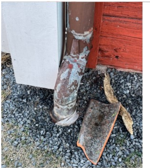
Flagnande, senare tillkommet stuprör med markanslutning. Dränering med synlig markduk och högt liggande grus, som på sikt kan orsaka fuktskador. Nedfallen, trasig tegelpanna.
