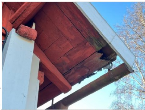
Fuktskadad träpanel i takfot, norra delen
