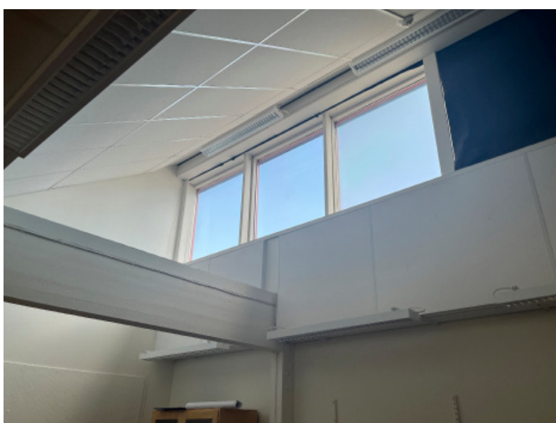
Upphöjda fönsterband mot nordost ger dagljus till de djupa klassrummen. Innertaken har klätts med nya ljuddämpande plattor.
