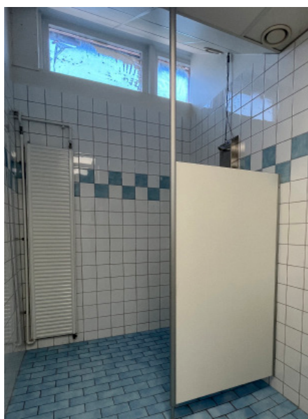
Omklädningsrummen delade tidigare duschrum men en skiljevägg har satts upp för att ge varje omklädningsrum ett separat duschrum.
