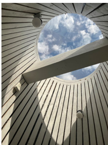
En av två lanterniner som ej satts igen.
