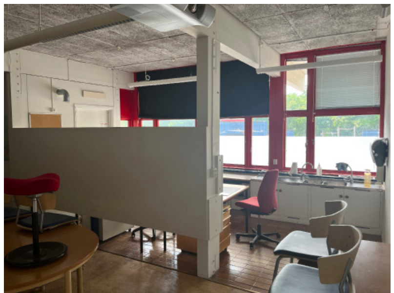
Ett av klassrummen har ej försetts med nytt undertak. Här är de ursprungliga träullplattorna synliga. Notera klinkergolvet som markerar kapprummets gräns mot klassrummet.
