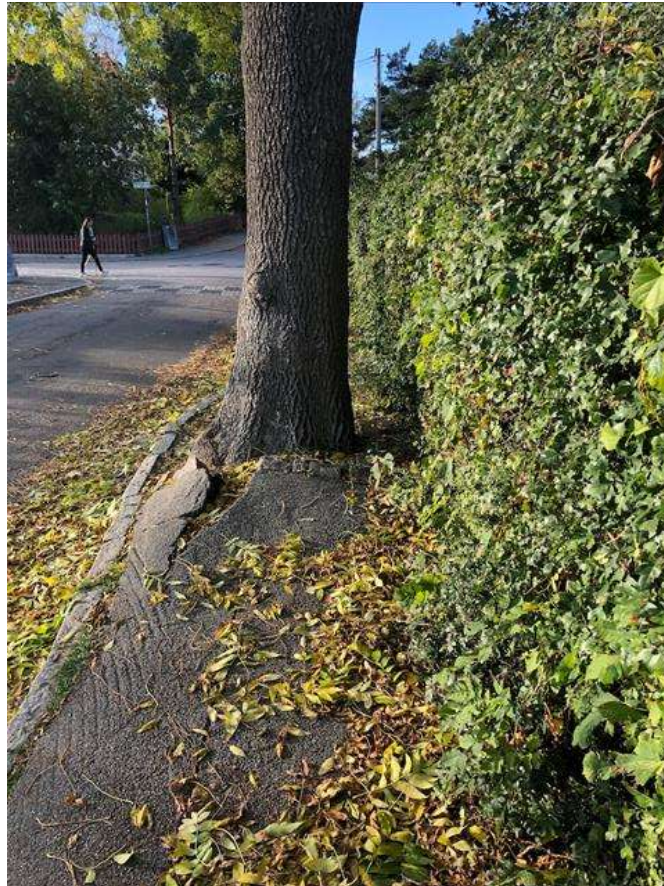
Figur 6: Träden på Pukslagargatan blockerar befintlig gångbana och skadar beläggningsen.
