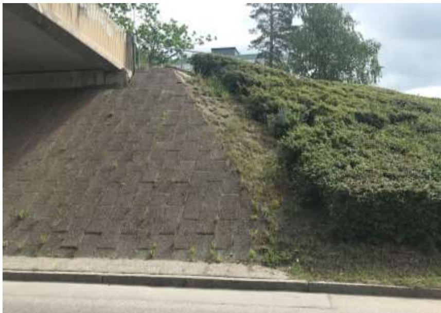
Betongslänt vid Andra Hagstråksbron, juni 2022.
