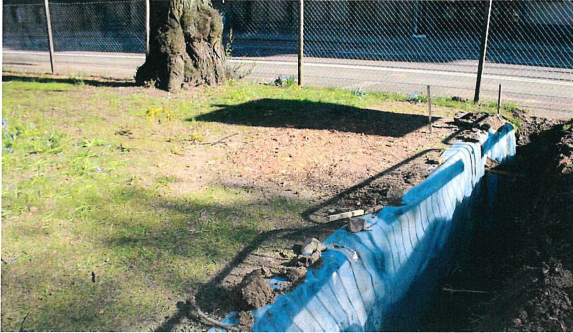
Bild 5. Rotdraperi av plast vid schaktvägg för att motverka uttorkning av jord och beskurna rötter.
