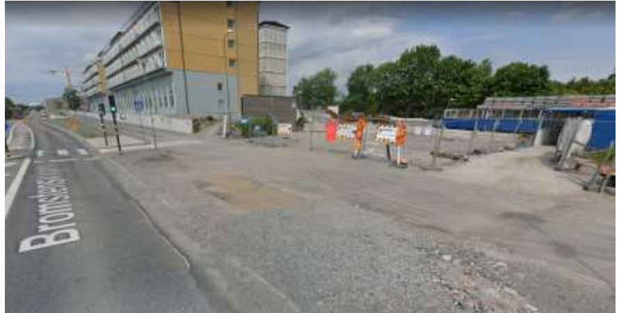
Bild 11. Fotografi över Trafikverkets bygginfart över gång- och cykelbanan vid Herdevägen. Första etappen av studentbostäderna uppförda.
