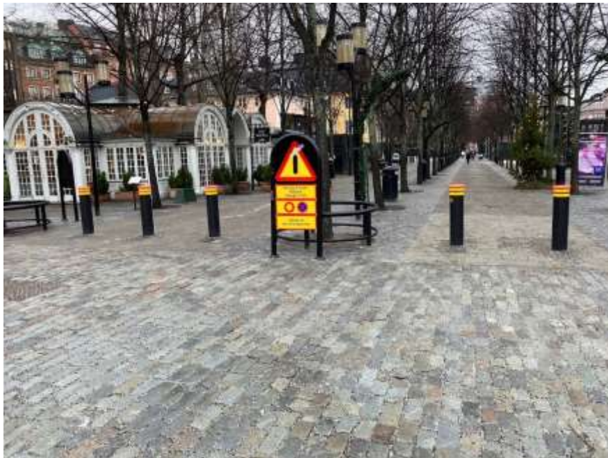
Bild 7. Entrén Vid Karl den XII:s torg. Fem pollare i upphöjt läge. Totalt har fem rörliga och två fasta pollare installerats vid plats 5.
