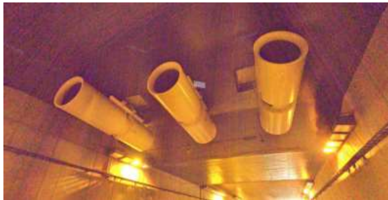
Bild 1. Tre stycken nya vita tunnelfläktar monterade i taket på Blekholmstunneln
