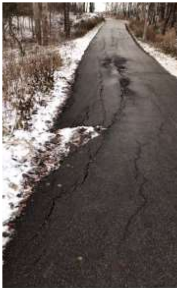
Bild 3. Bilden visar sprickor och ojämnheter i asfaltsbeläggningen på cykelbanan längs Stamdikesvägen innan åtgärd.
