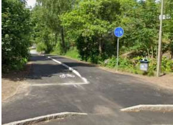
Bild 1. Gång- och cykelbana på Sulvägen. Bilden visar sliten och ojämn asfaltsbeläggning innan åtgärd.
