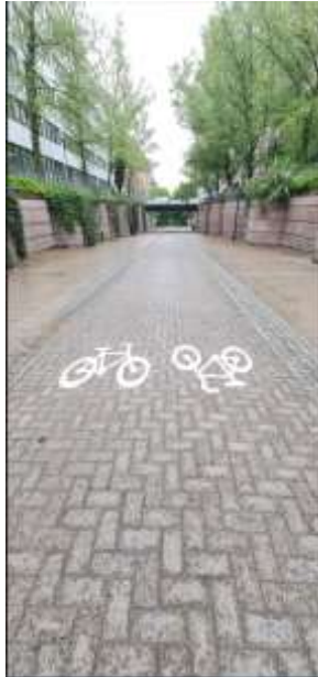
Bild 5. Bilden visar sliten marksten på cykelbanan längs Södermalmsallén innan omläggning.
