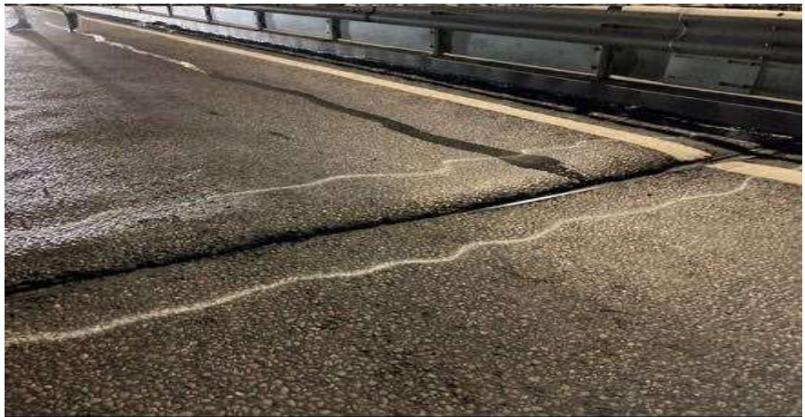
Bild 1. Klarastrandsleden, påfart Kungsbron norrgående, före åtgärd. Sträckan är ojämn med höga kanter och har håligheter.
