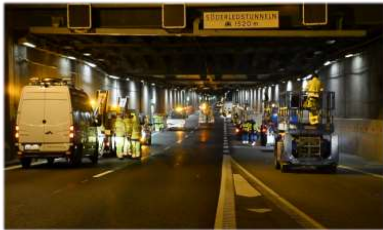
Bild 1. Fotografi från nattavstängning av Söderledstunneln. På bilden pågår underhållsarbeten inom olika teknikområden.
