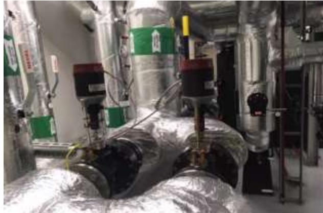
Bild 3. Fotografi från markvärmeundercentral. De olika styr- och reglersystemen samspelar för en optimal drift.
