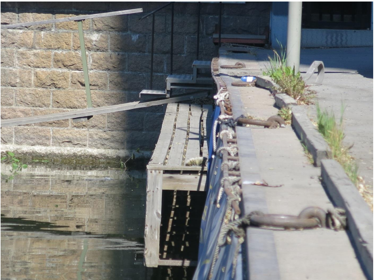
Bild 11: Kajen har kalvat i norra delen mot slussen.
