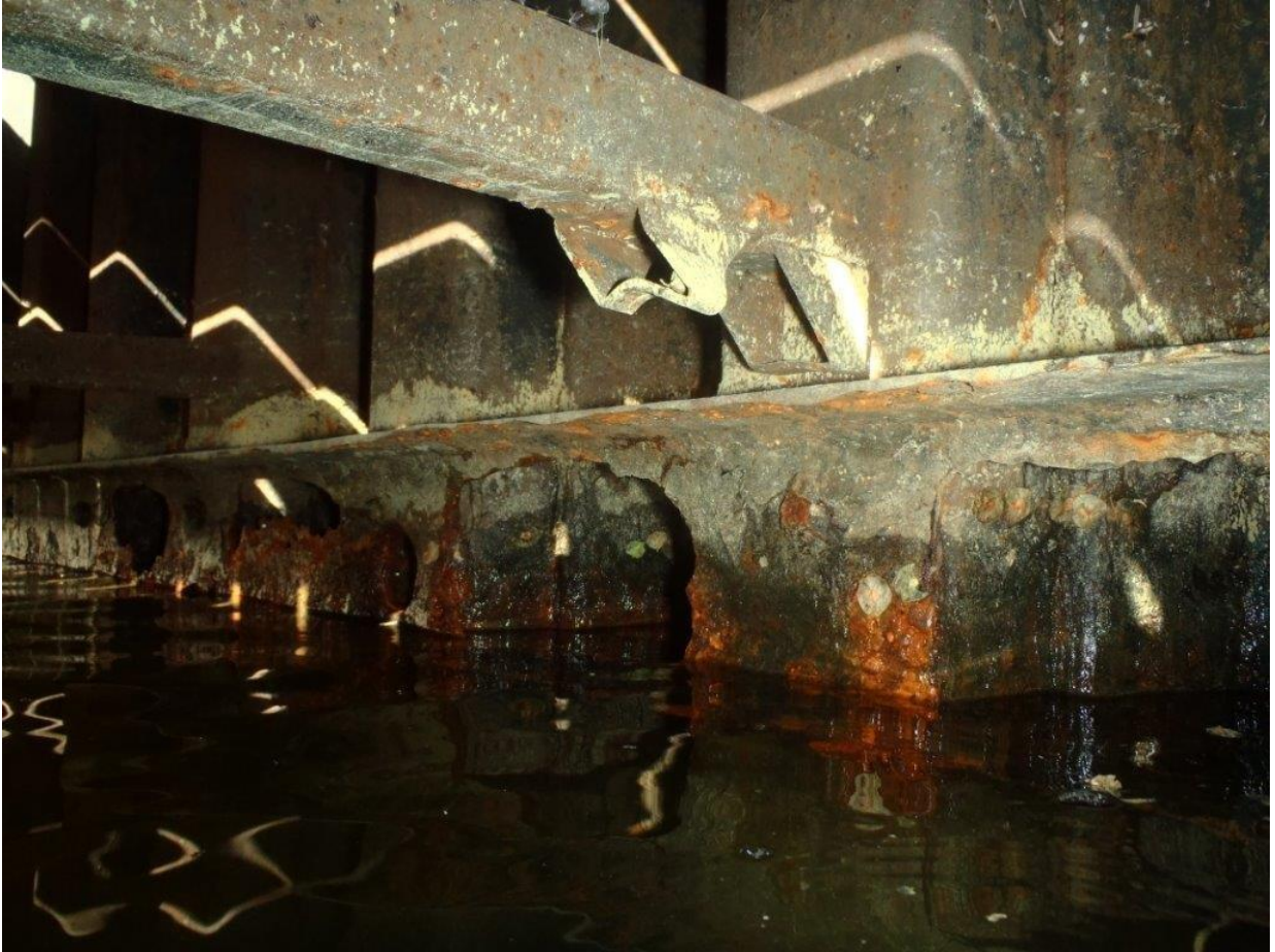
Bild 4: Korrosion i hammarband.
