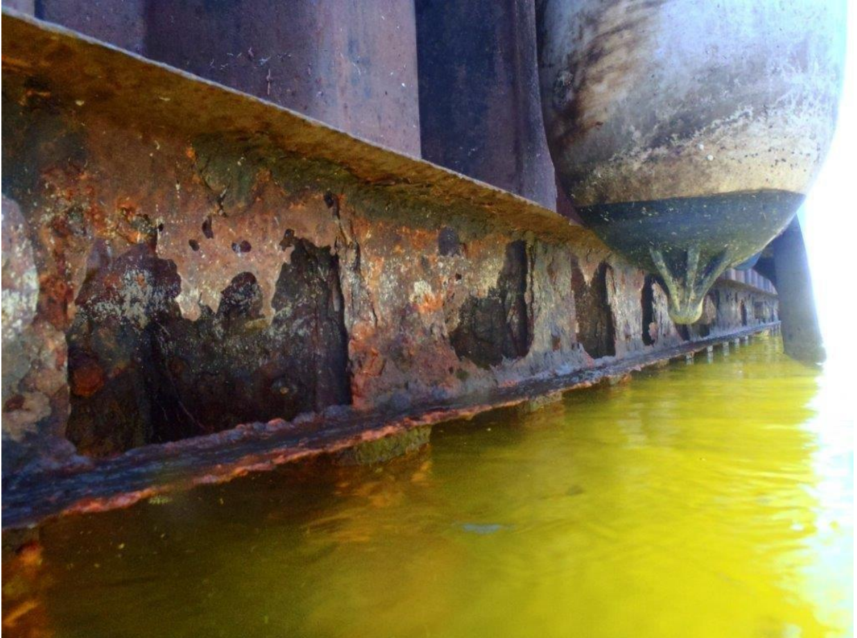
Bild 6: Korrosion i hammarband.
