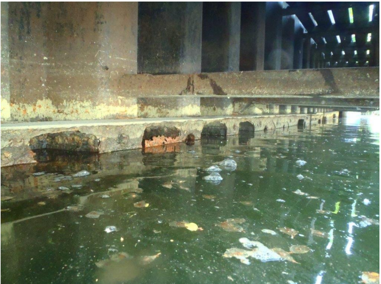
Bild 5: Korrosion i hammarband.
