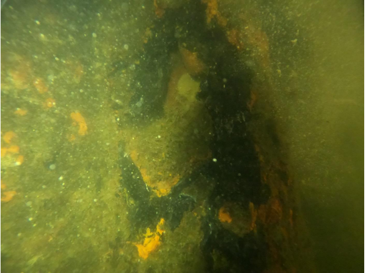
Bild 10: Korrosionshål i spont.
