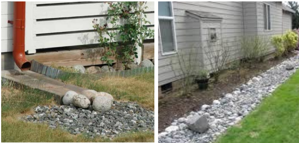
Figur 26. Till vänster, och till höger stuprörsutkastare med rännal och erosionsskydd som avleder takvattnet ut till grönyta. Till höger, makadamdike i trädgårdsmiljö.
