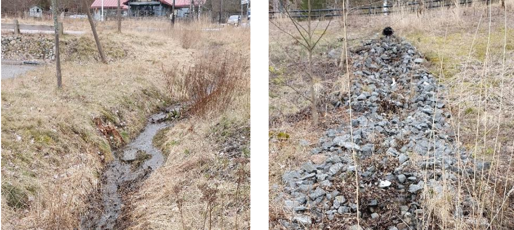
Figur 15. Exempel på rinnstråk med utlopp inom planområdets norra del. Till vänster från delavrinningsområde D och till höger delavrinningsområde F.
