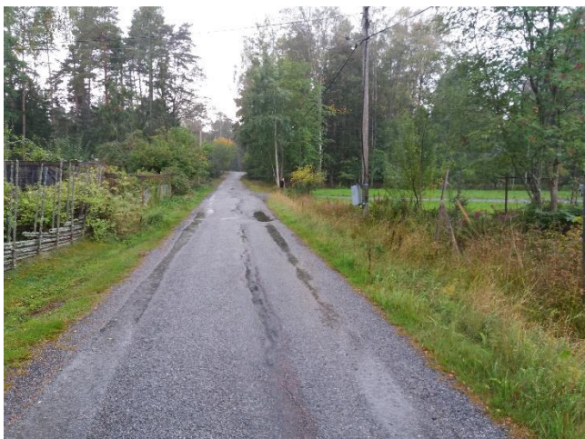
Figur 15: Flugsnappevägen, bild tagen i sektion ca 0/180 i riktning söderut. Vägsador i form av sprickor och hjulspår kunde här tydligt observeras.
