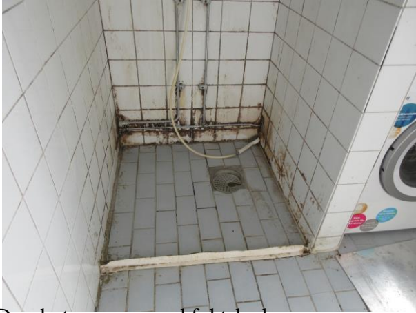
Duschtrymmen med fuktskador
