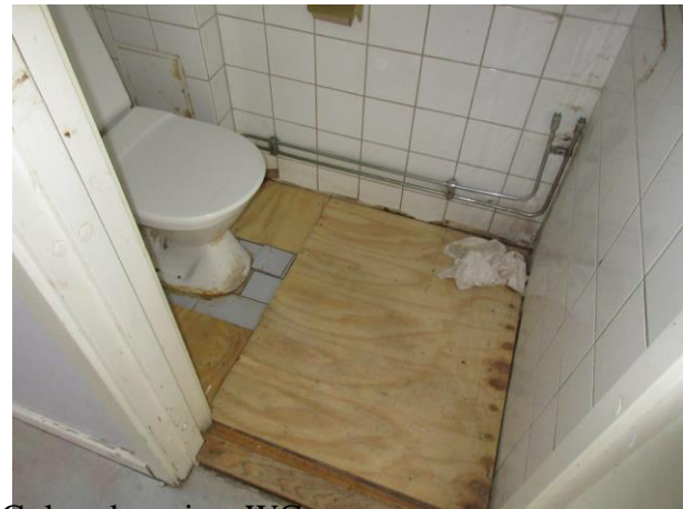
Golv saknas i en WC
