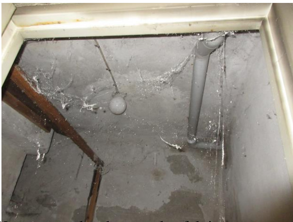
Utrymme under altan mycket fuktigt.
