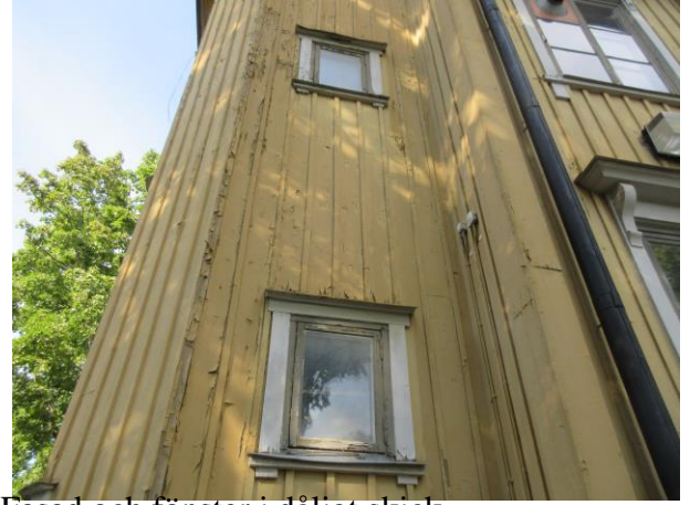
Fasad och fönster i dåligt skick.
