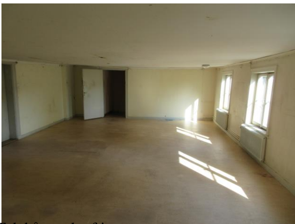
Tak bågningar kraftigt.
