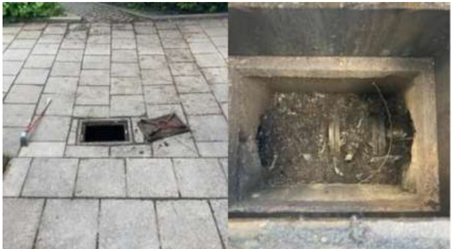
Bild 3. Fotografi som visar ventilbrunn med påfyllningsventil innan utbyte..
