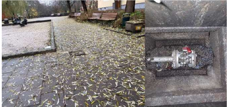
Bild 4. Fotograf som visar ventilbrunn med påfyllningsventil efter utbyte.
