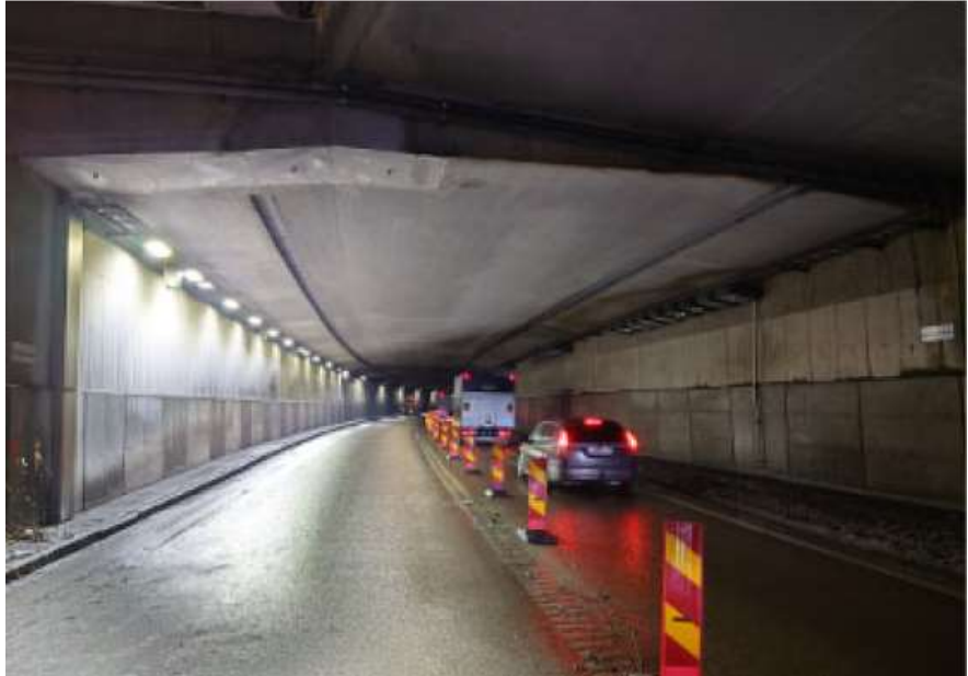
Bild 2. Fotografi som visar den nya belysningen till vänster och den gamla belysningen släckt till höger. Bilden är tagen mot Karlbergstunnelns södra infart.
