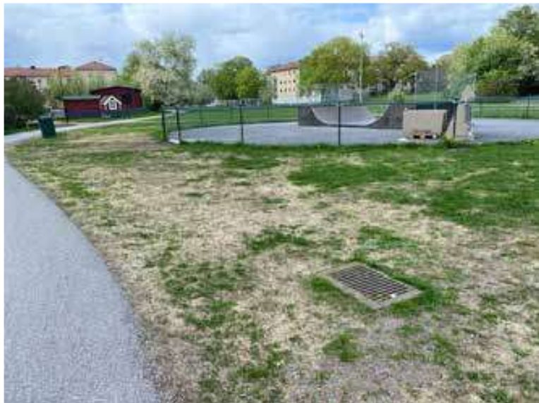
Stående vatten har lett till skadade gräsytor
