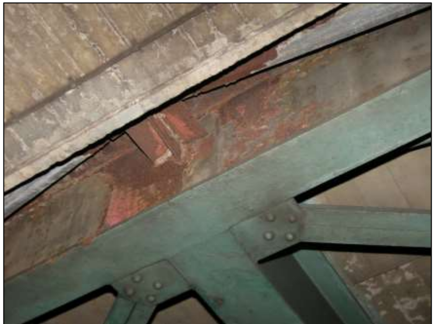
Figur 2: Fotograf som visar rostangrepp på brons ändtvärbalk (th) och tunnelbanans tråg (tv).
