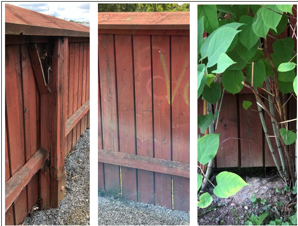
Figur 5. Exempel på otätheter hos befintlig bullerskyddskärm längs med Tyresövägen.
