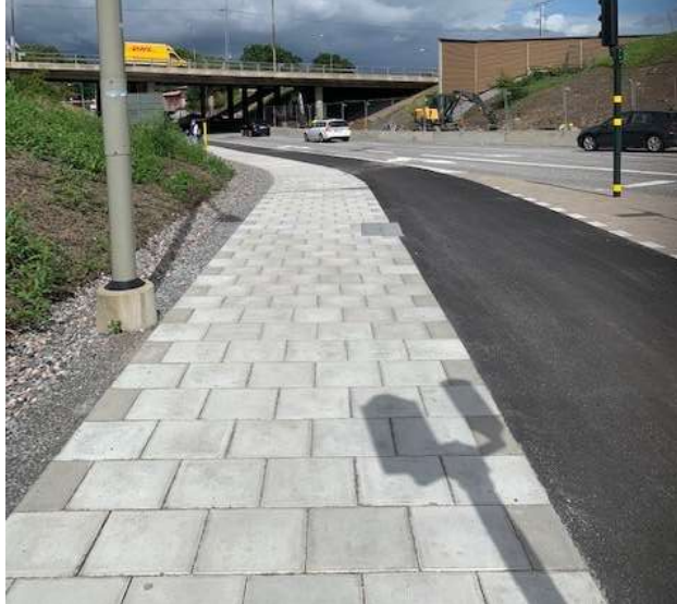
Bild 5 Fotografi som visar Gamla Tyresövägen från Sandåkravägen sett efter ombyggnaden. Trafikverkets/exploateringskontorets bullerskärmar till höger i bild. Gångbana med plattor och cykelbana med asfalt.
