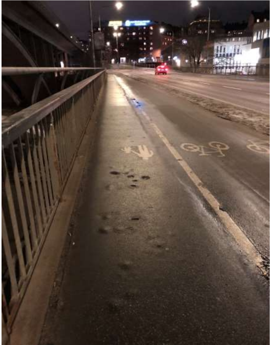
Figur 7. Skador i belägningen i form av blåsor på den norra Skansbron och längsgående sänka intill separeringslinjen mellan gång- och cykelbana.
