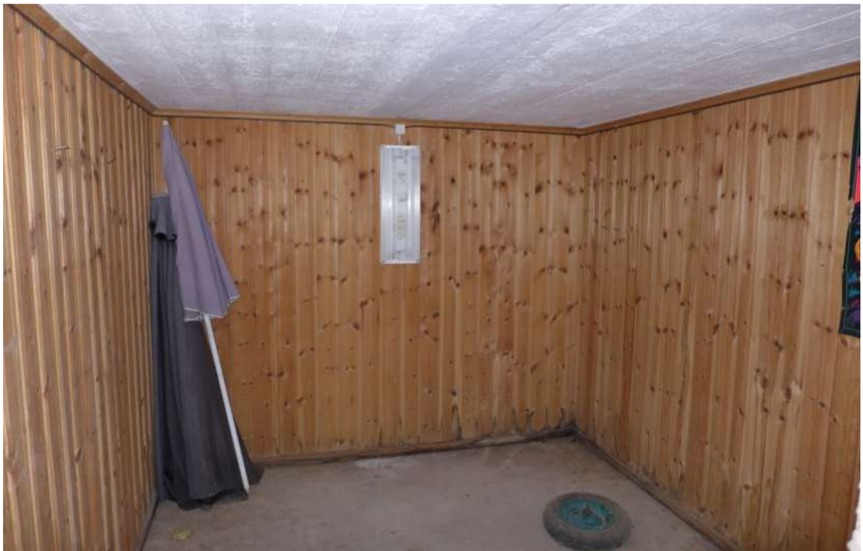
Rum 102 Förråd. Fuktskadad tunn fanerad träpanel.
