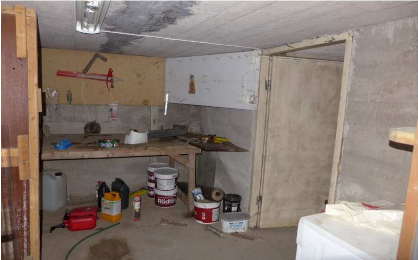
Rum 103 Teknikrum. Arbetsbänk och tvättmaskin. Dörr mot Rum 101.
