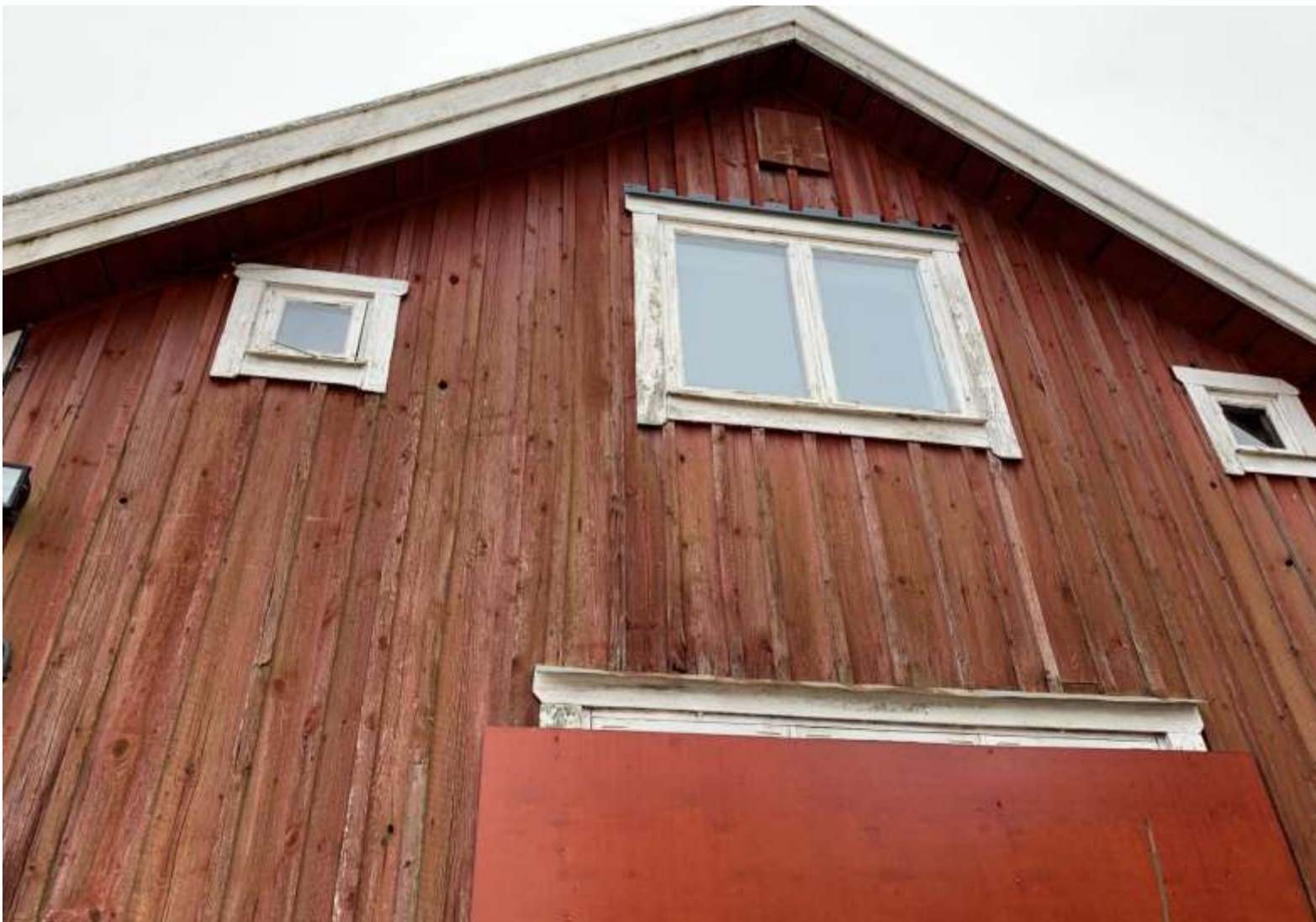
Fasad mot norr. Nött färg. Rostiga fönsterbleck och felaktigt monterat överbleck på fönster stora fönstret till övervåningen.
