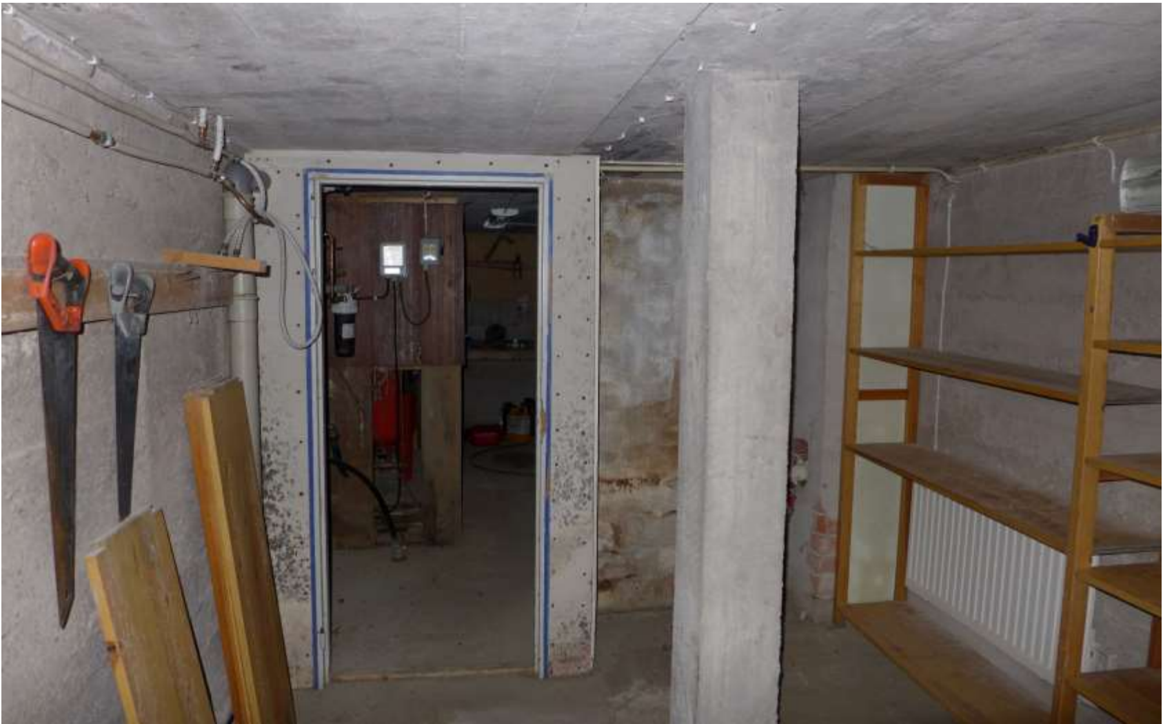
Rum 104. Förråd. Gipsvägg kring dörr med mögel. Murstock i hörnet med putsbortfall och hål.
