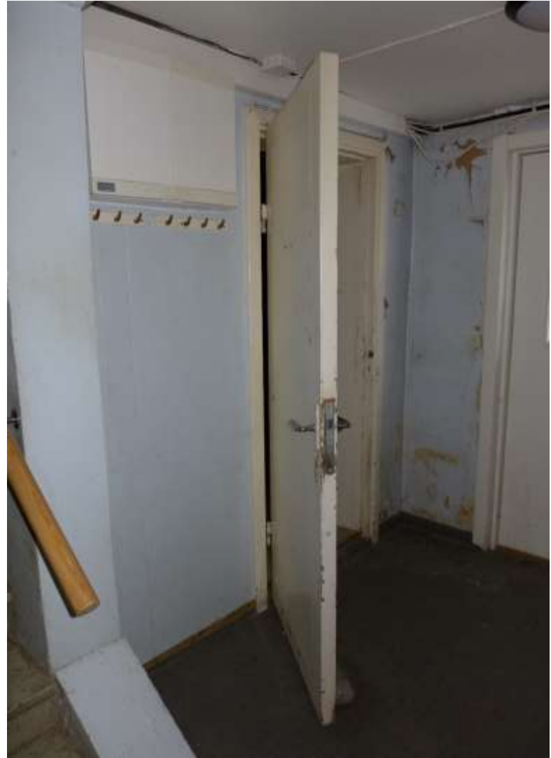
Bottenvåning. Hall 201. Dörr mot 204 kök. Elcentral. Löst kablage. Sliten dörr. Väggar med färgbortfall.
