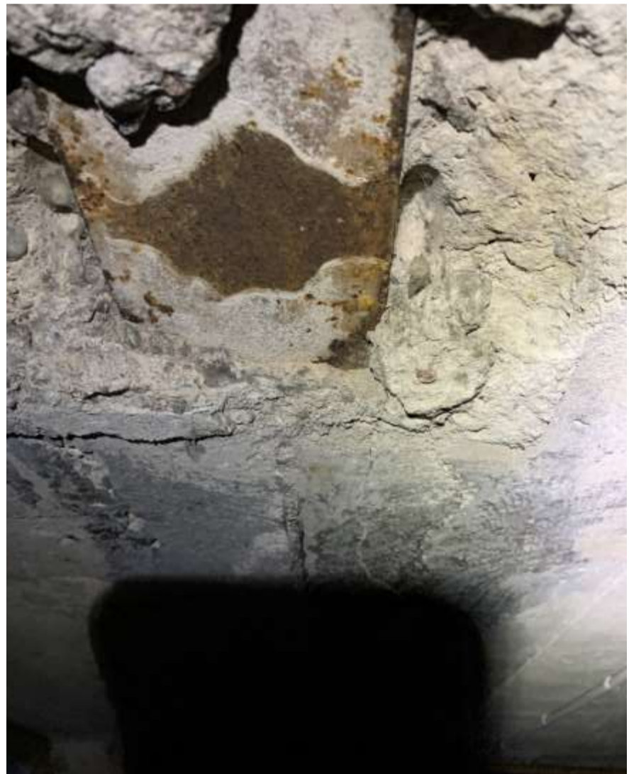
Rum 103 Teknikrum. Rostig takbalk.
