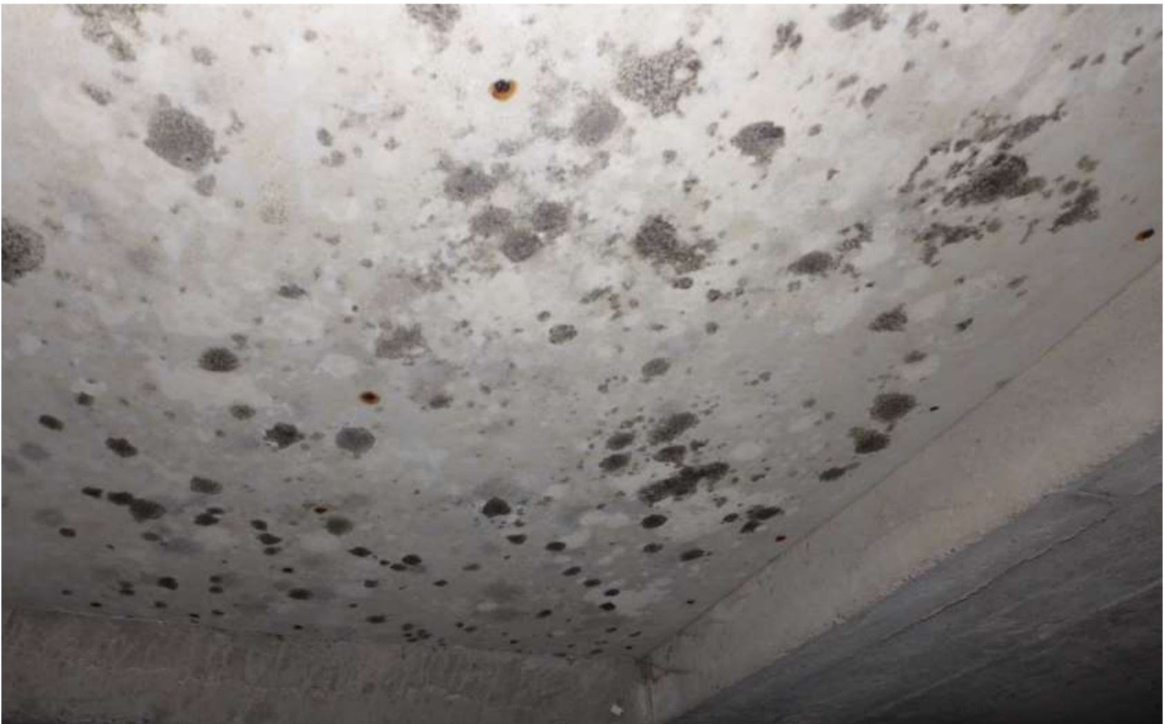
Rum 104. Förråd. Hål i betongbjälklag igensatt med gips som möglat.
