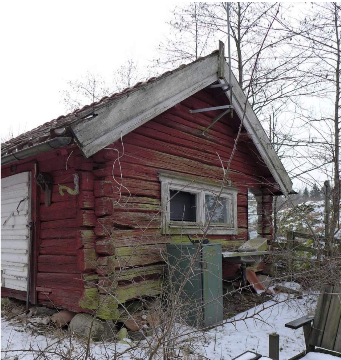
Fasad mot öst och sjön. Vindskivor med nött färg och eventuell röta.
