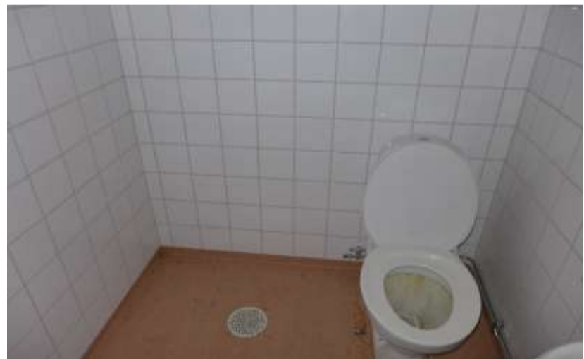
Rum 205 WC Tvättstuga. Losskopplade rör. WC-stol med missfärgad skål.
