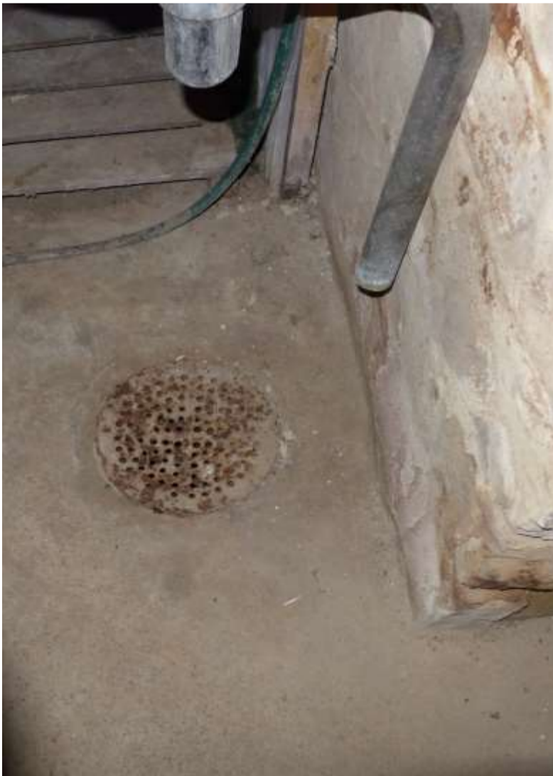
Rum 103. Rostig golvbrunn.
