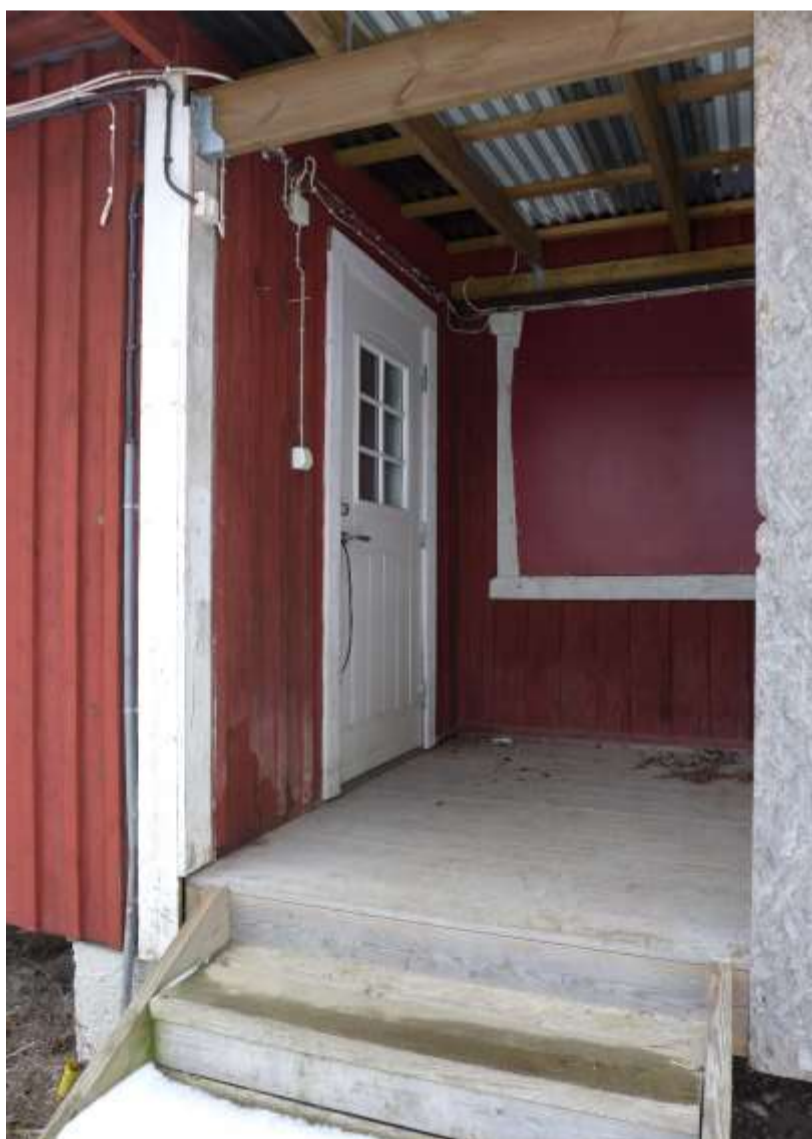
Entré. Omålad stomme till skärmtak ser ofärdigt ut. Plasten i skärmtaket har varierat i utseende. En stor mängd kablar
