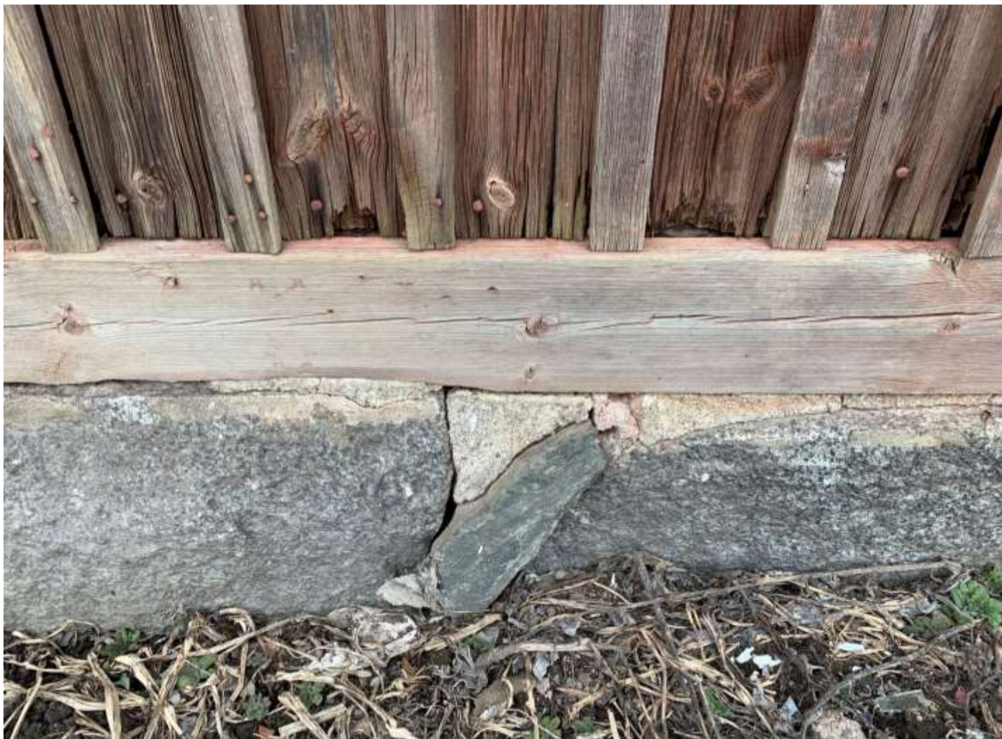
Fasad mot söder. Detalj. Röta fasadpanel. Omålningsbehov, offerbräda. Spruckna fogar i grundmur.
