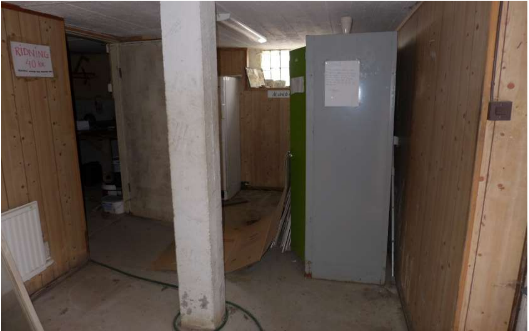
Rum 101 Hall, omklädningsrum. Väggar med fuktskadad tunn fanerad panel. Löst innerfönster anas till vänster.
