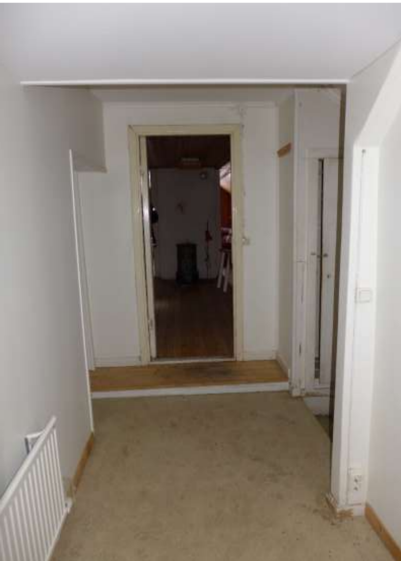
Rum 301 Hall. Vy mot trappa och rum 304. Del med lackat trägolv som är smutsigt och nött.
