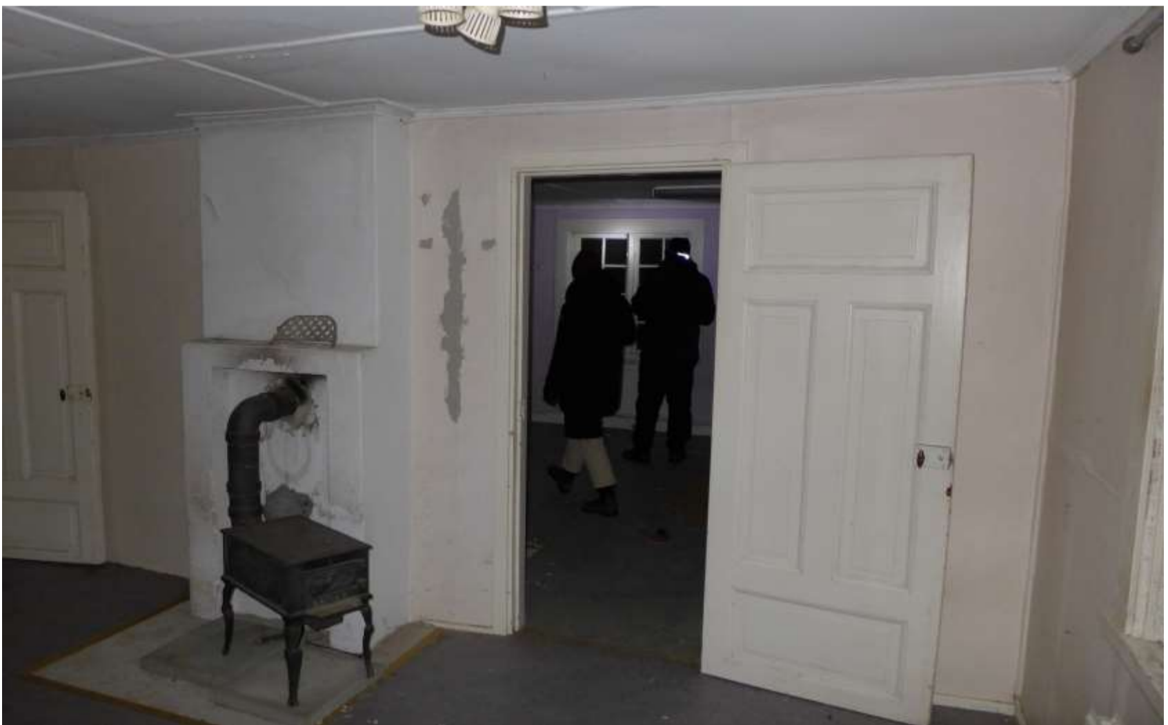
Rum 203, Kammare. Vedspis ansluten till murstock. Kapade dörrar. Nedsjunken sockel.
