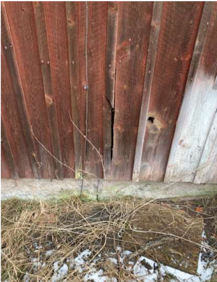
Västra fasaden. Missfärgad panel vid vattenutkastare. Skadad panel och locklist.
