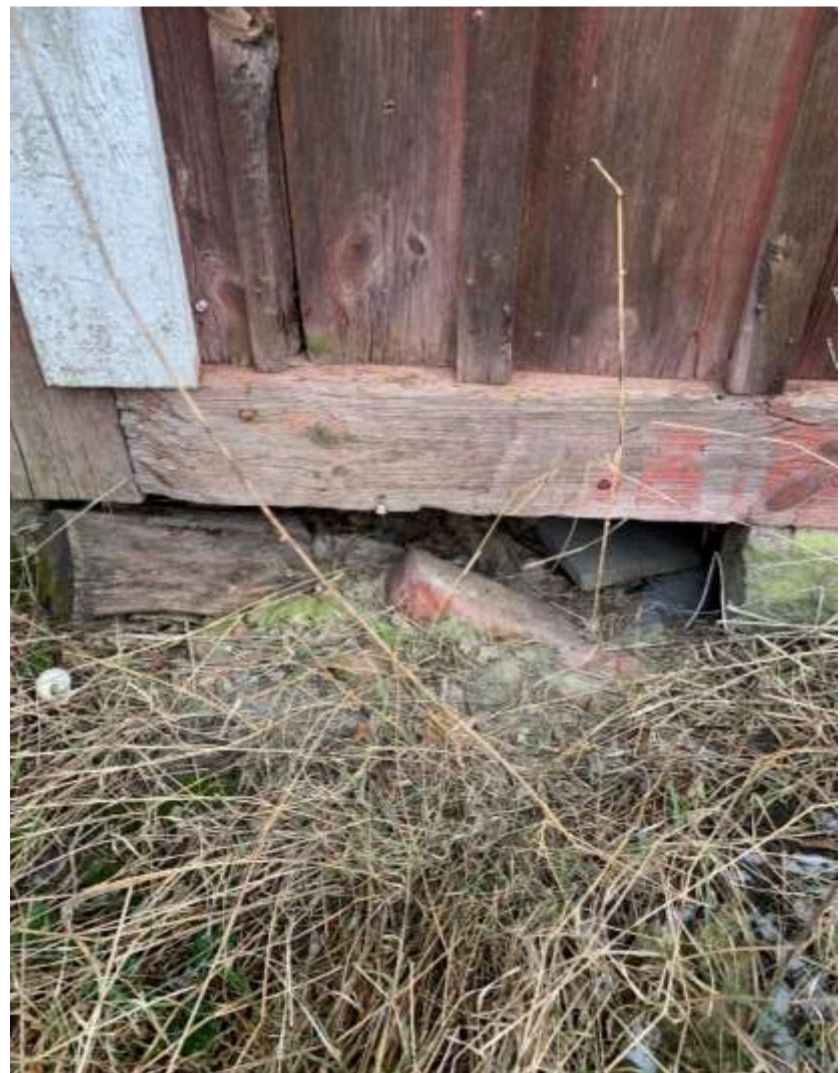
Västra fasaden. Del av grundmur saknas.
