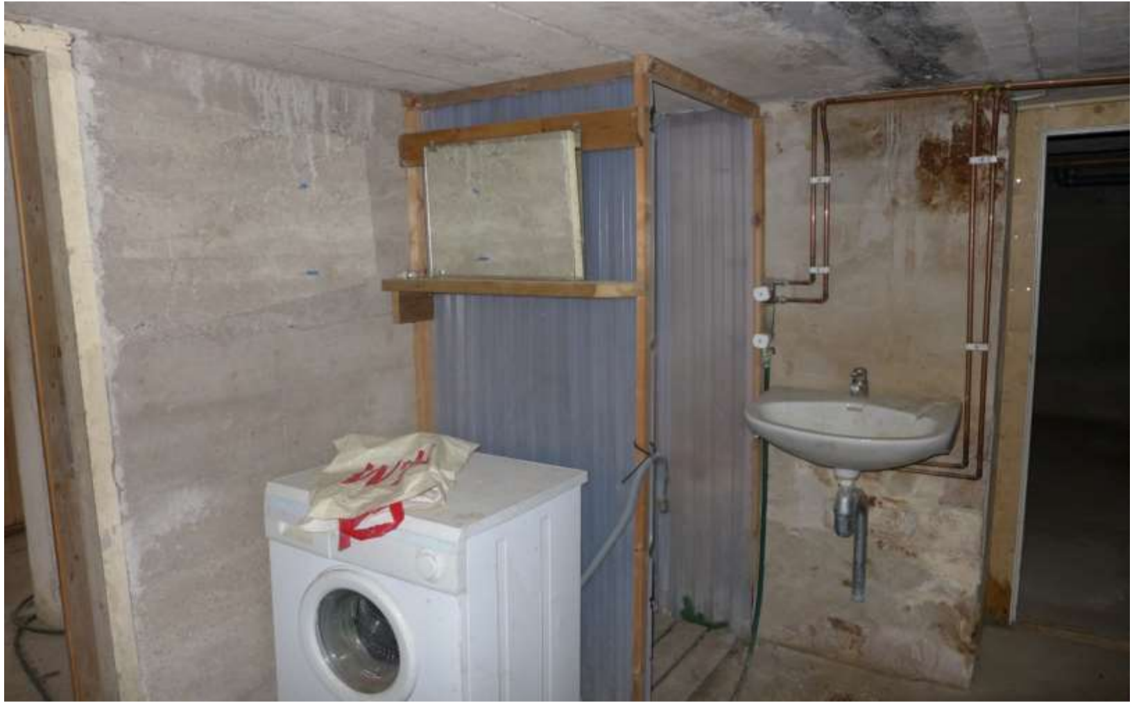
Rum 103 Teknikrum. Handfat utan inkopplat avlopp. Dusch av trä och plast utan avlopp. Tvättmaskin som ej är avloppsansluten. Vid dörr plyfa som väggbeklädnad som fuktskadats.
