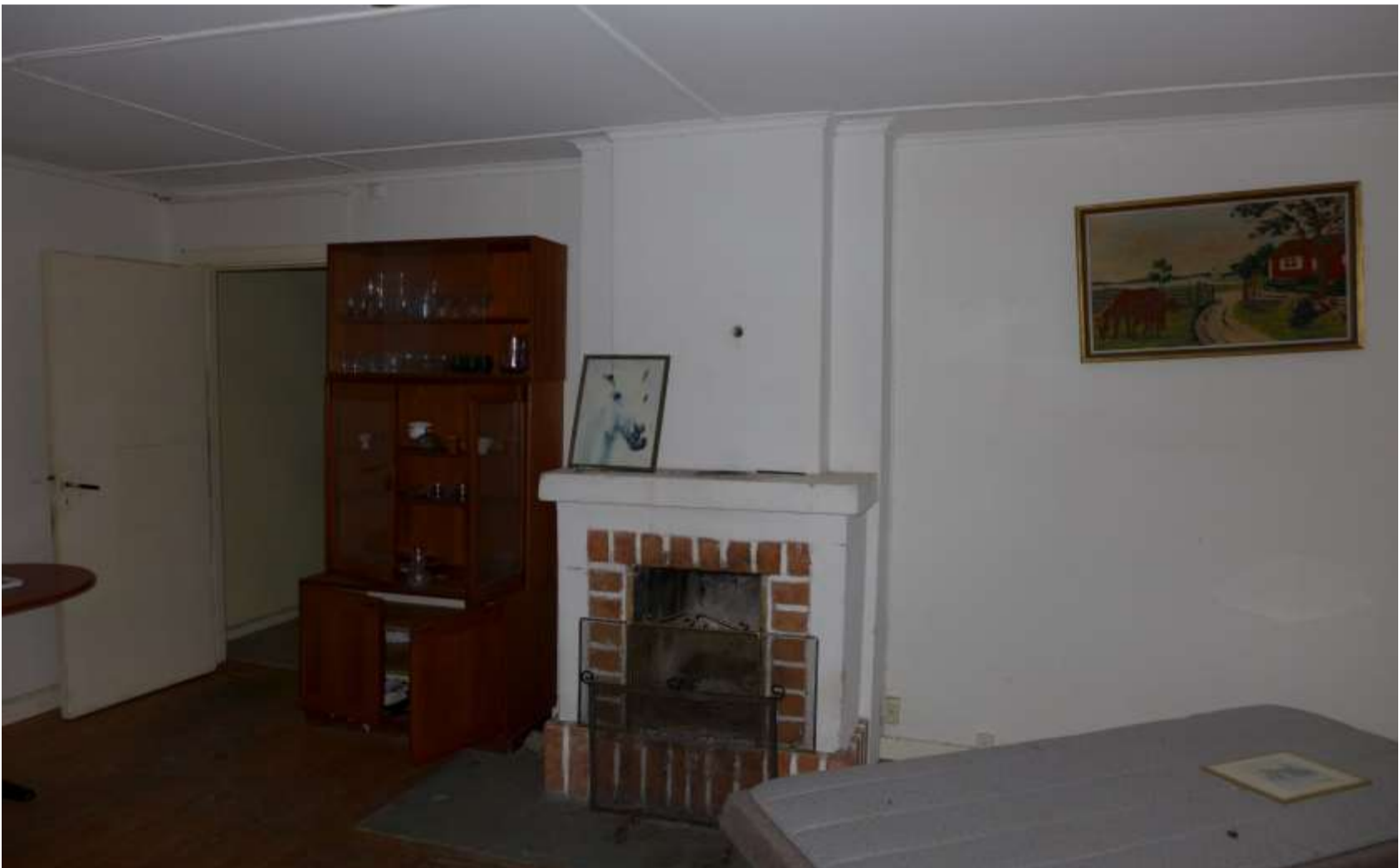
Rum 206. Öppen spis med ev trasigt spjäll. Gnistskydd med sprickor.
