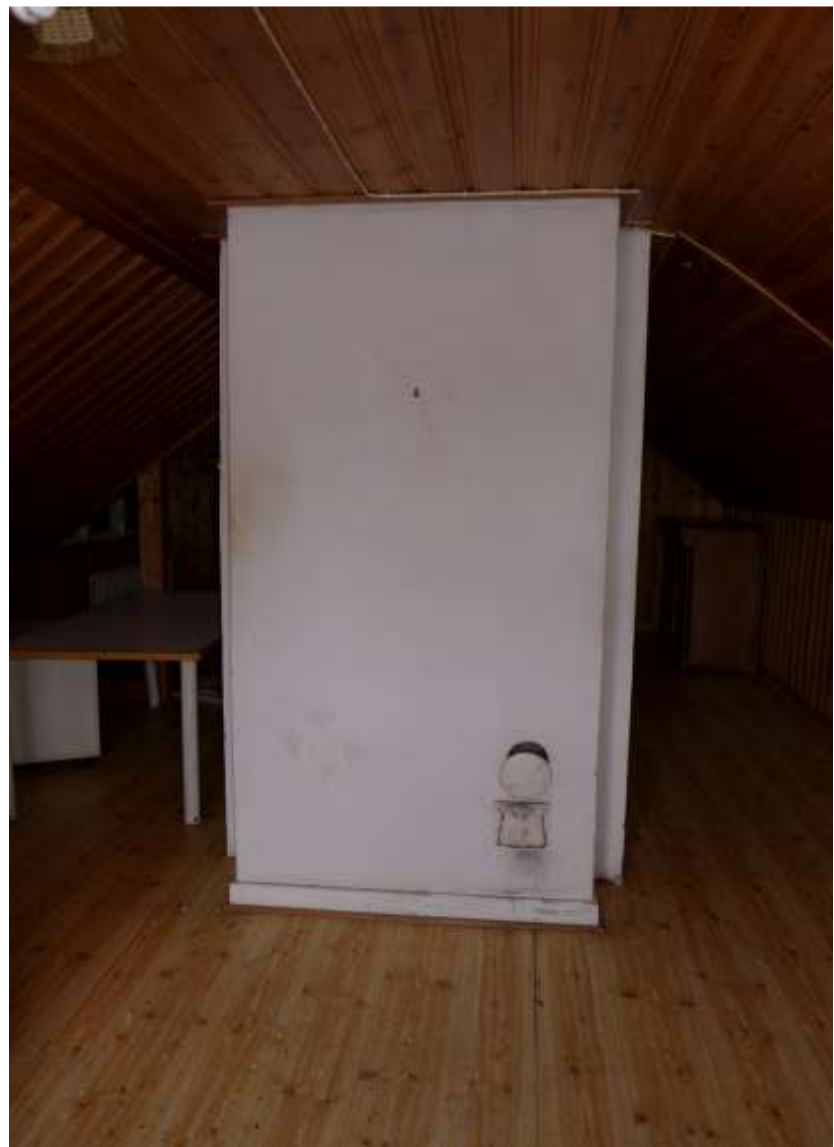
Rum 304. Murstock med smuts småsprickor.
