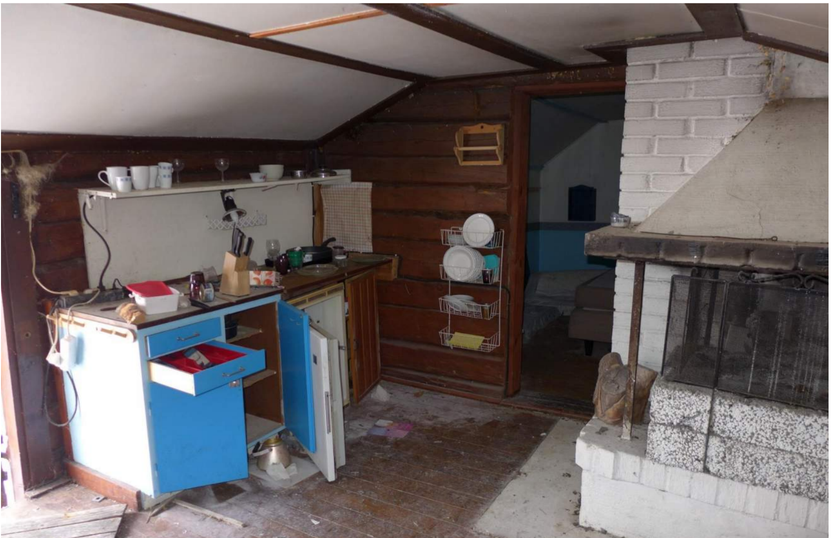
Rum 101. Köksinredning med nött färg. Innertak som buktar nedåt och har list instucken. Öppen spis med smuts och sprickor.
