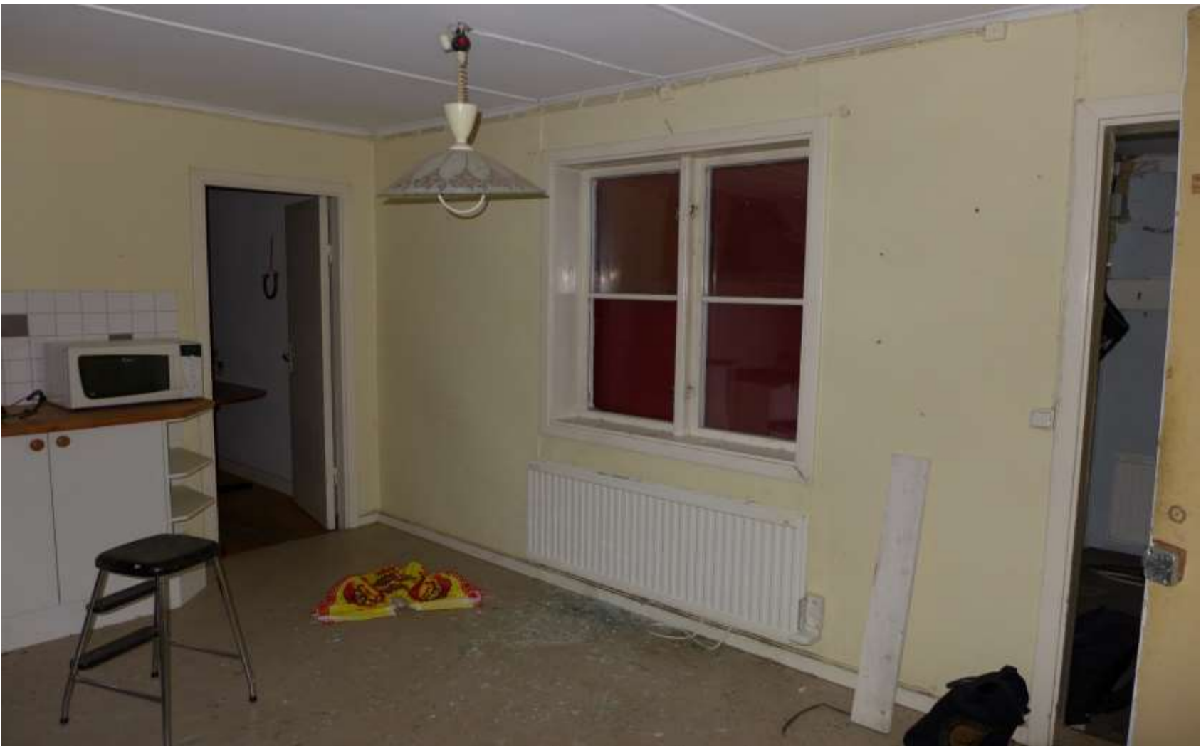
Rum 204 Kök. Trasigt glas.Smutsiga väggar med mindre skador. Till höger dörrblad till skafferi med omålad insida.
