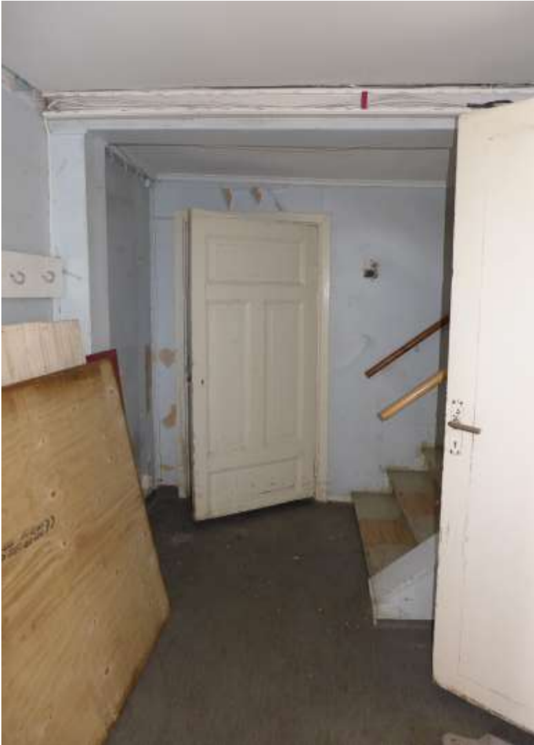
Rum 201 Hall. Spegeldörr mot rum 202, kapad i underkant och påbyggd i överkant. Trappa till övervåning med pålimmade mattor.
