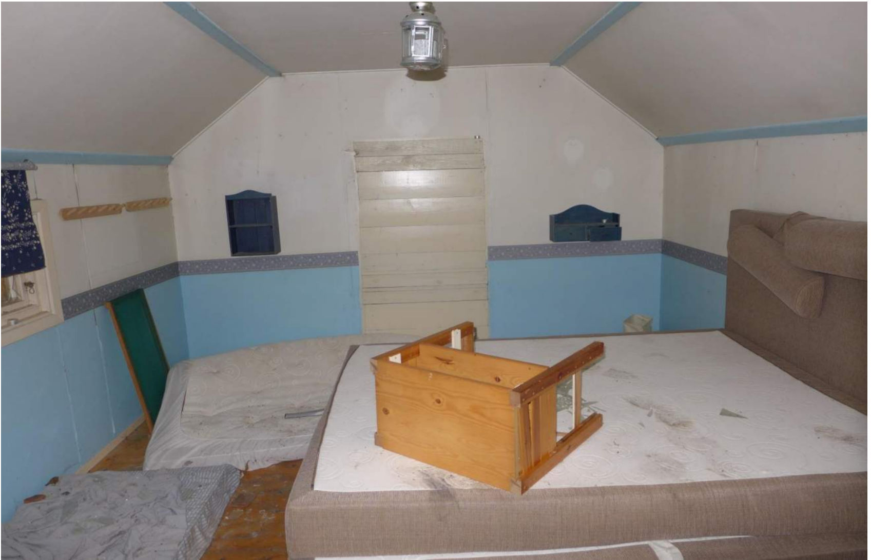
Rum 102 Sovrum. Fönster med trasigt glas. Väggar med sprickor i skivskarvar. Nött golvlack.
