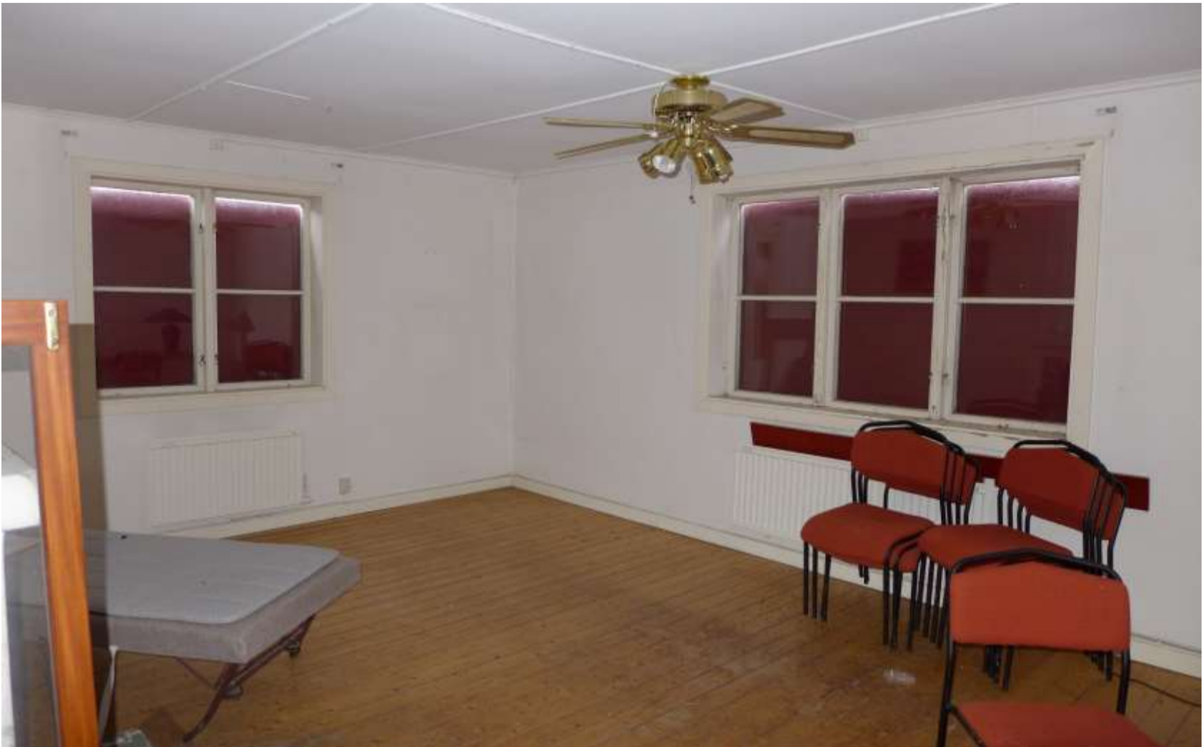
Rum 206. Nött golv. Fönster och väggar med färgsläpp.
