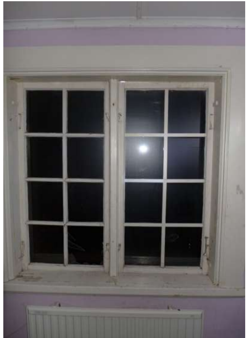
Rum 202 Kammare. Fönster mot väster. Trasigt glas. Färgsläpp. Högra fönsterbågen lagad med helt glas och fuskpröjs.
