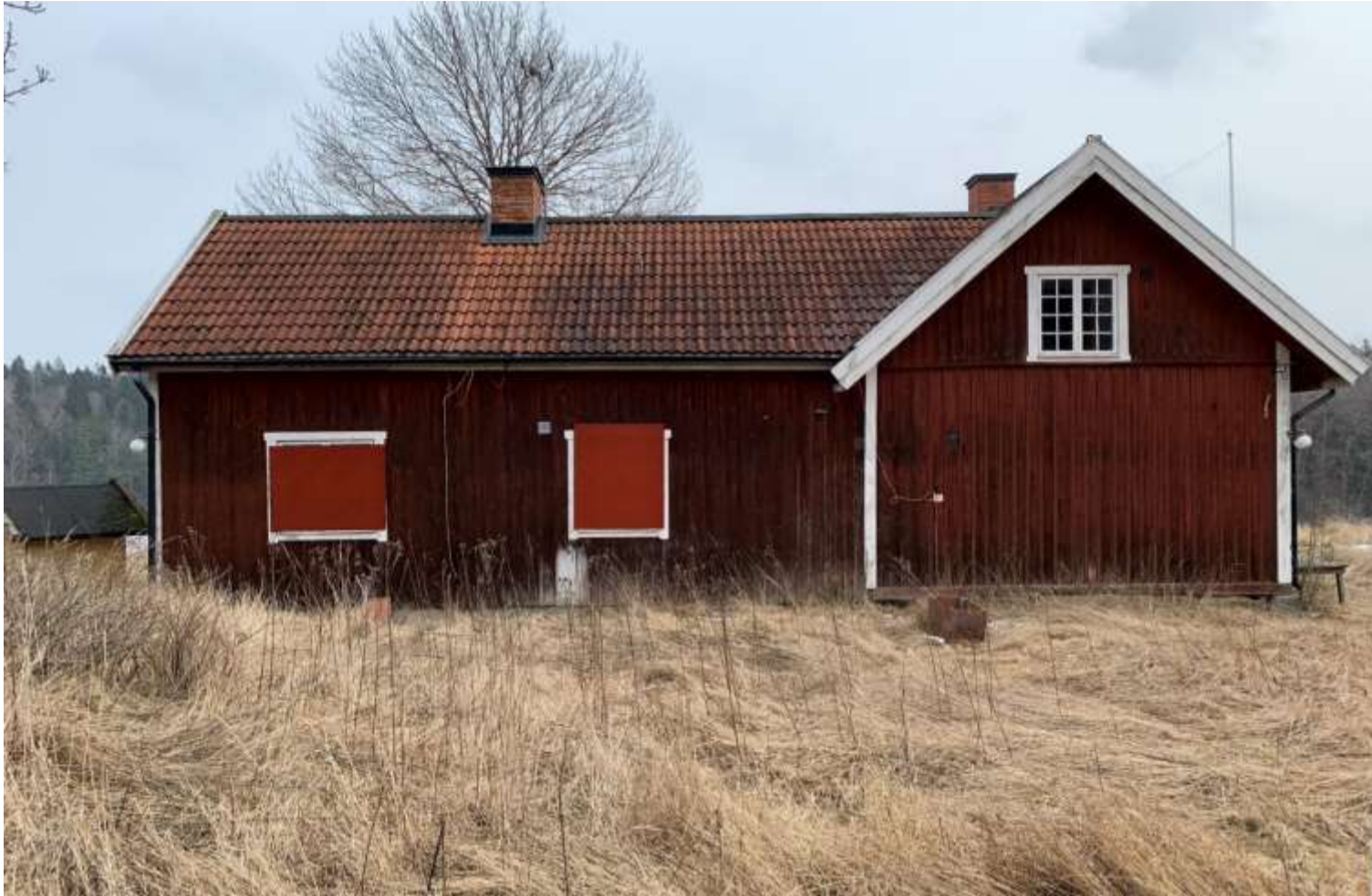
Fasad mot väster. Färg vittrad.
