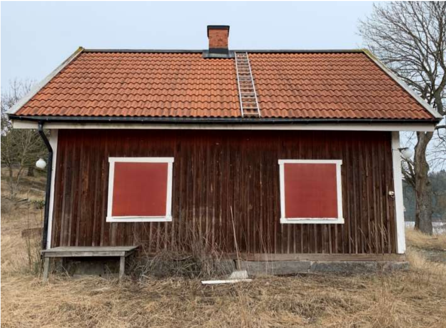
Fasad mot söder. Färg nött.
