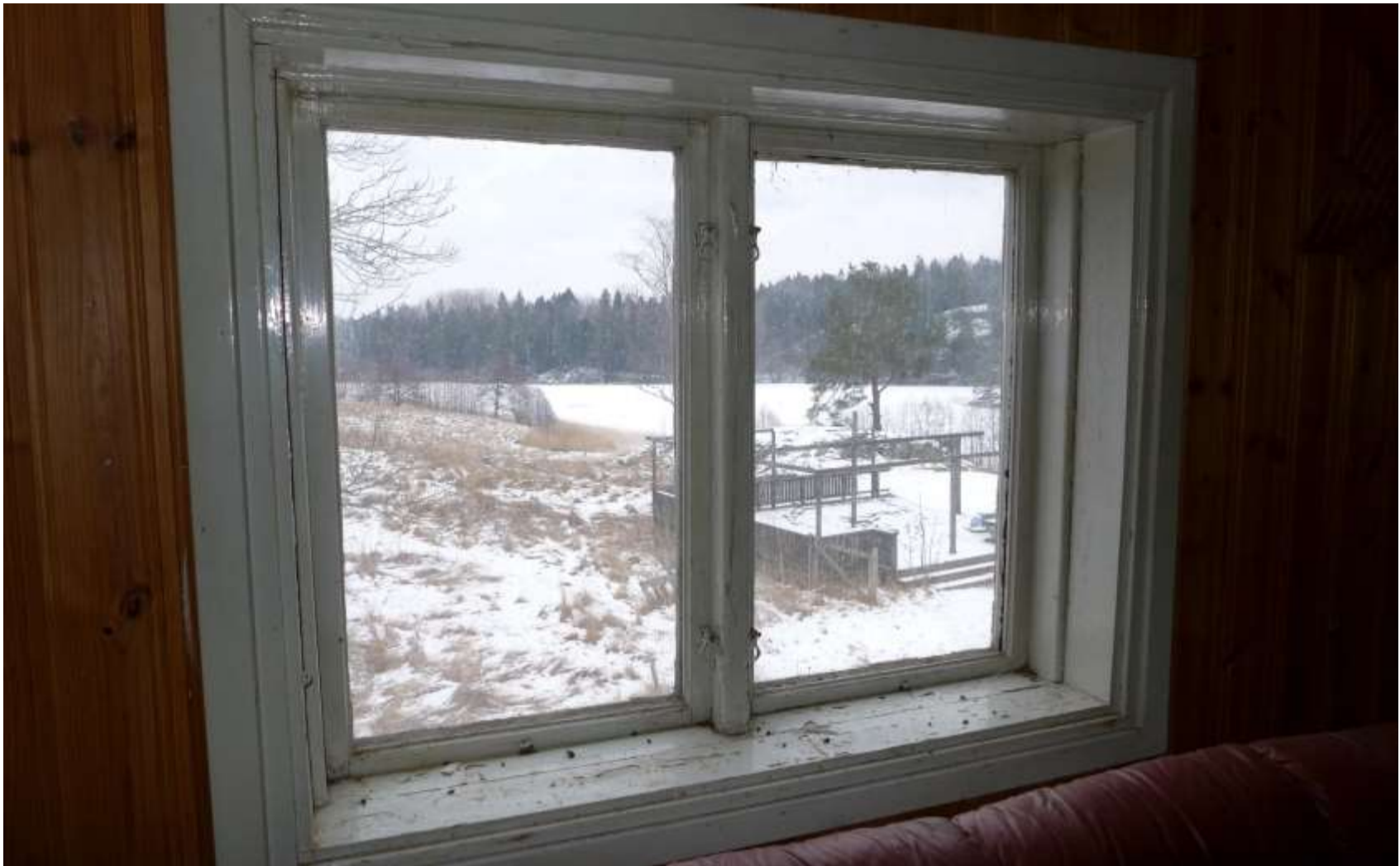
Rum 304. Fönster med färgsläpp.
