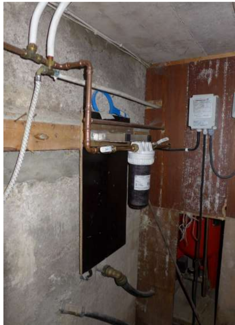
Rum 103 Teknikrum. Inkommande vatten och filter.
