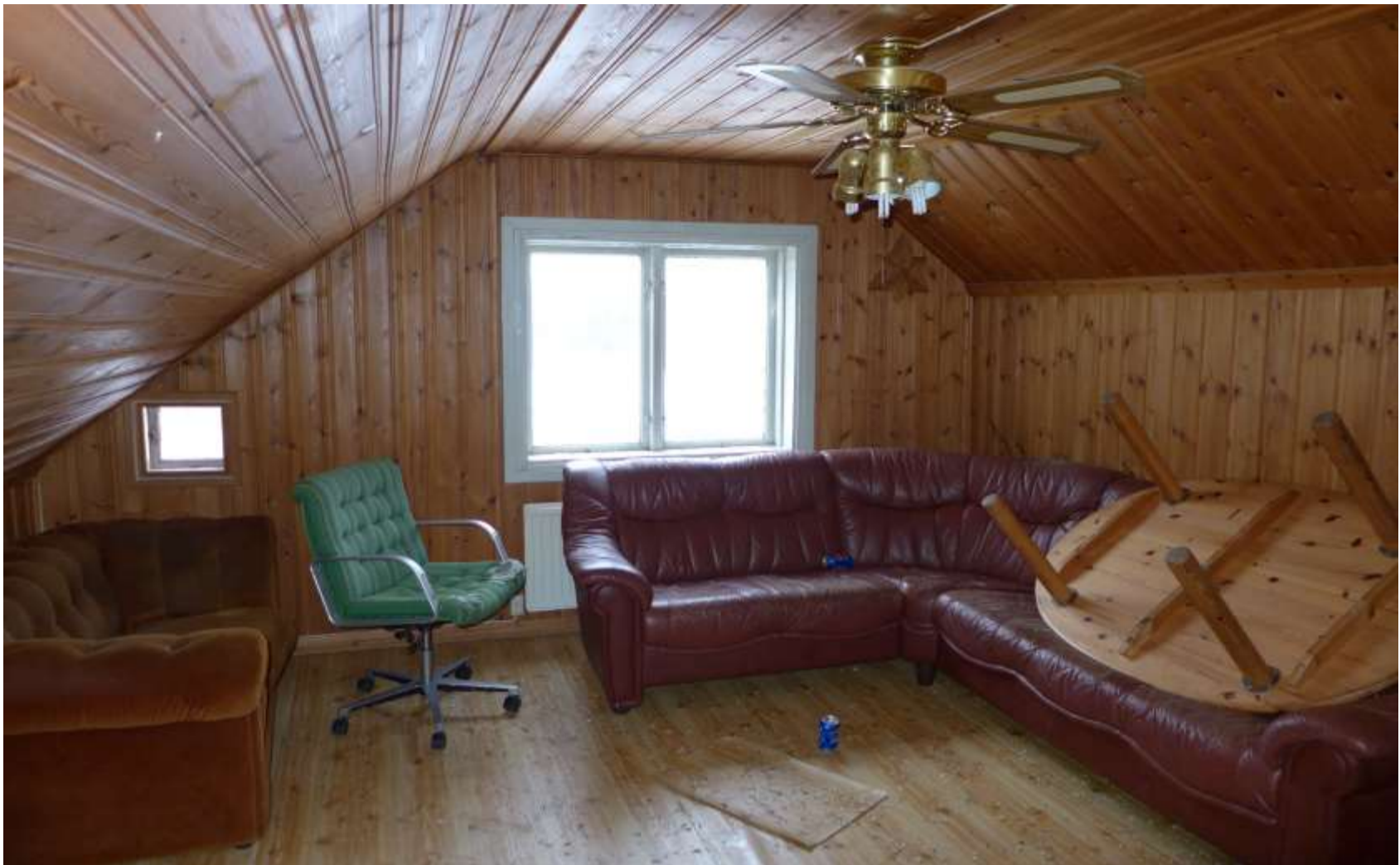
Rum 304. Fönster med färgsläpp.
