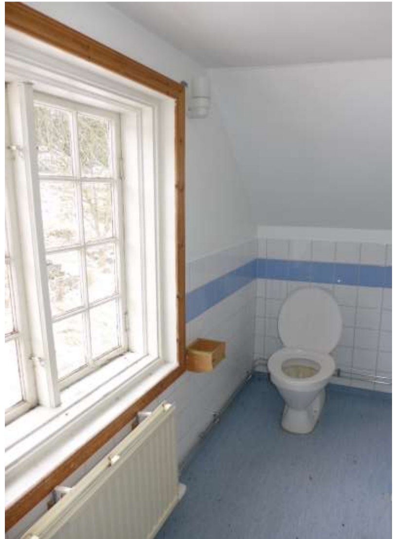
Rum 303 Badrum. Missfärgning i WC-stol.
