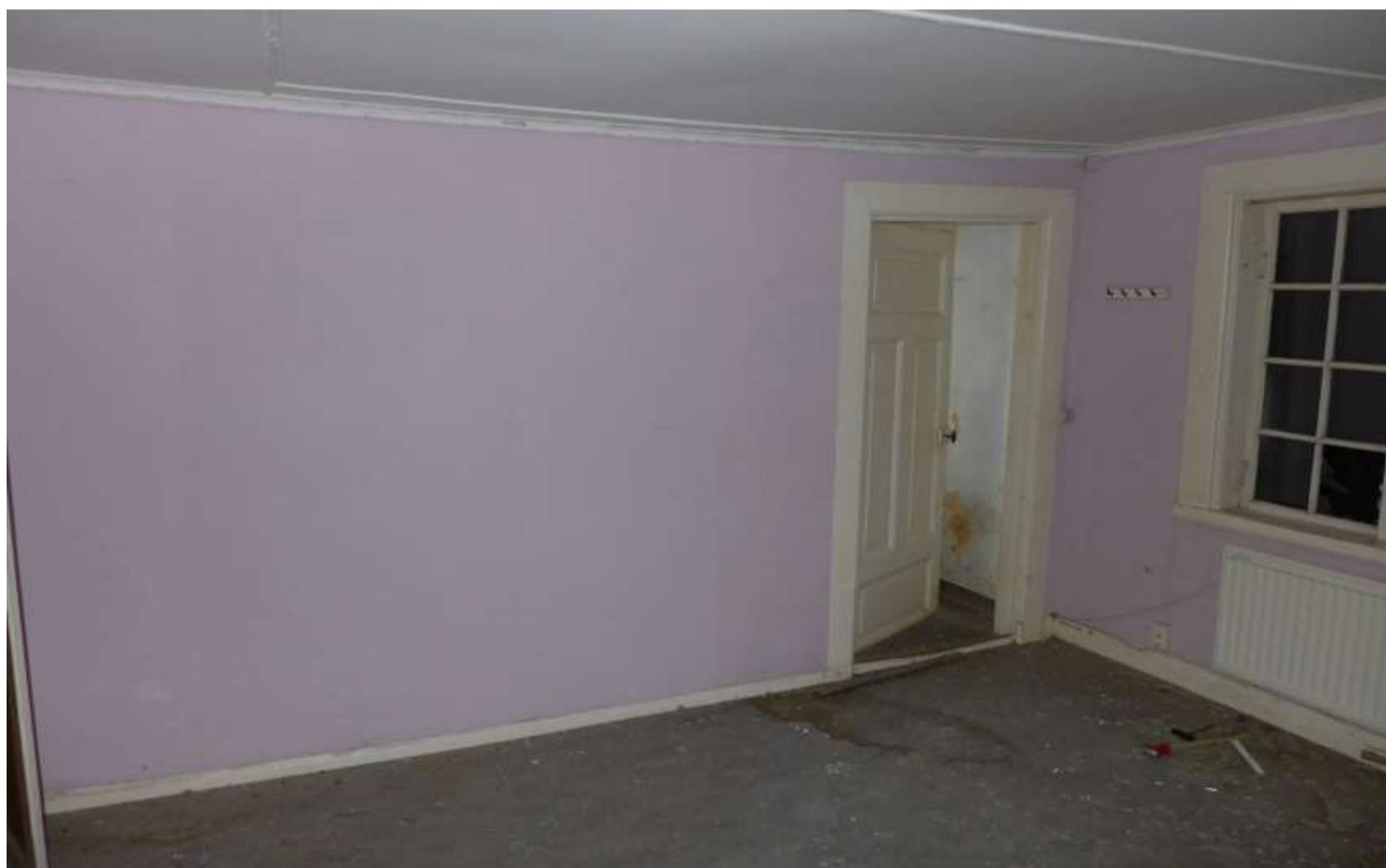
Rum 202 Kammare. Nedsjunken sockel. Tak med färgsläpp.
