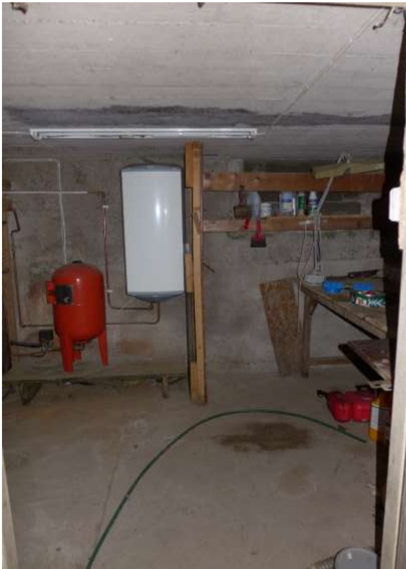
Rum 103 Teknikrum, Varmvattenberedare och hydrofor och pump. Trä i direktkontakt med fuktig betong.
