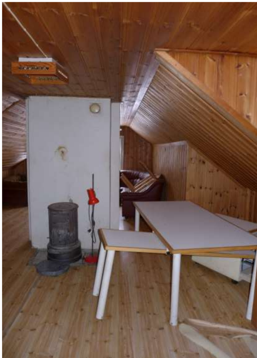
Rum 304. Golvmatta med skador.
