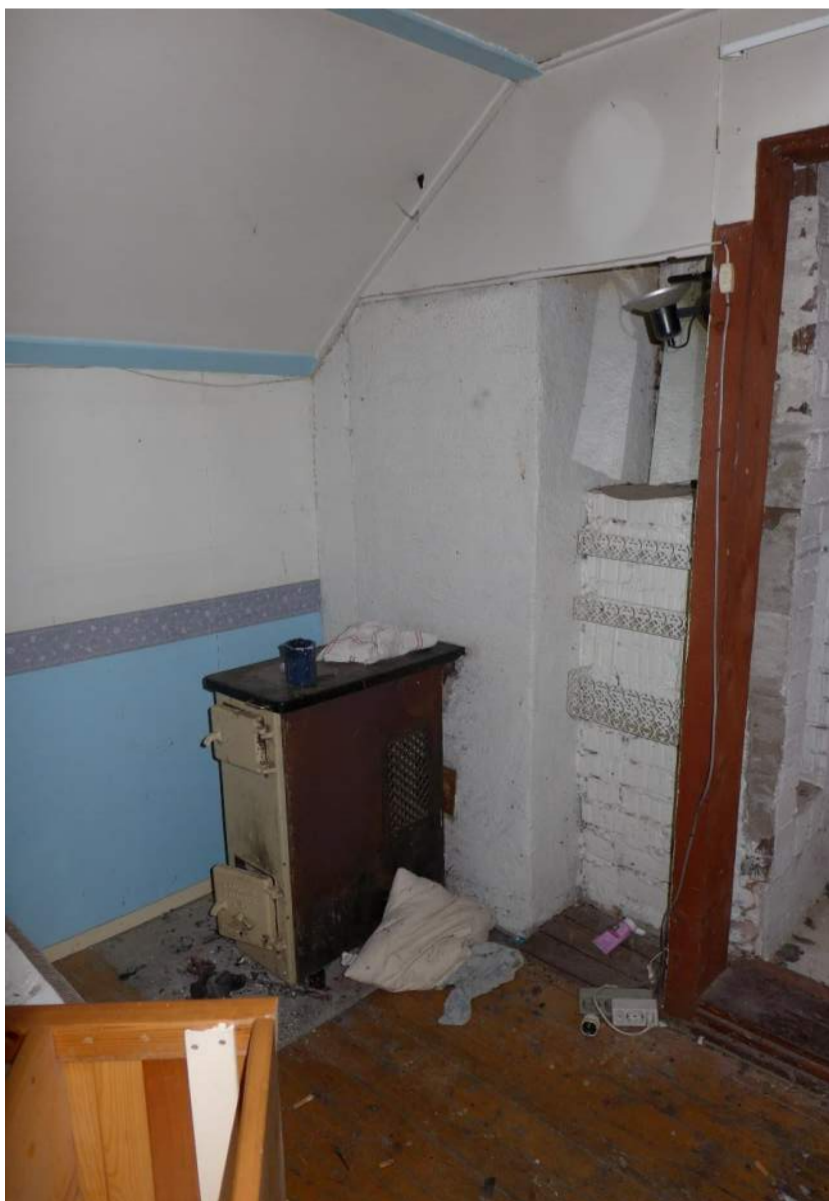
Rum 102 Sovrum. Rostig kamin. Murstock med nött färg. Nött lackat trägolv.
