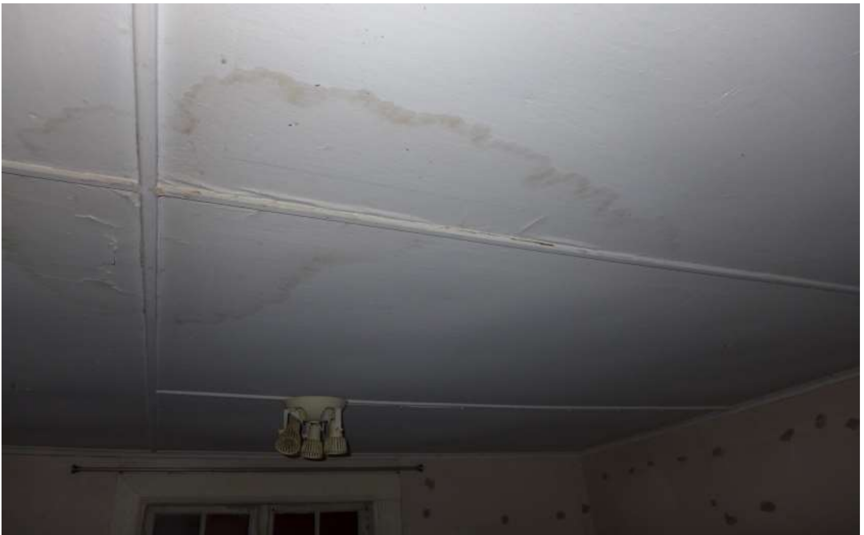
Rum 203, Kammare. Vattenskada i tak.
