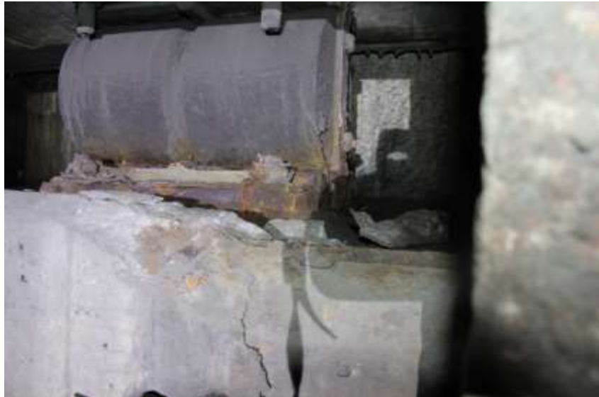
Figur 4: Fotografi som visar skador på en av västra landfästets lagerrullar av stål och lagerundergjutningar i betong.
