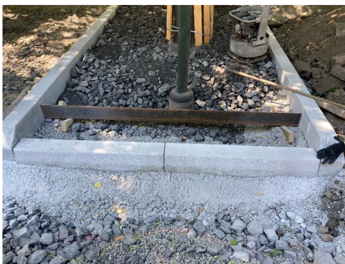
Figur 4: renoverad yta under träd, med biokol & makadam som släpper in vatten, samt kantsten som skyddar träden från bilparkering.
